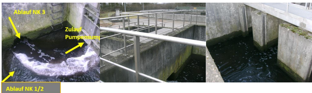
Bild 3: Zulaufschacht und Pumpensumpf des Schneckenhebewerkes der Filtration
