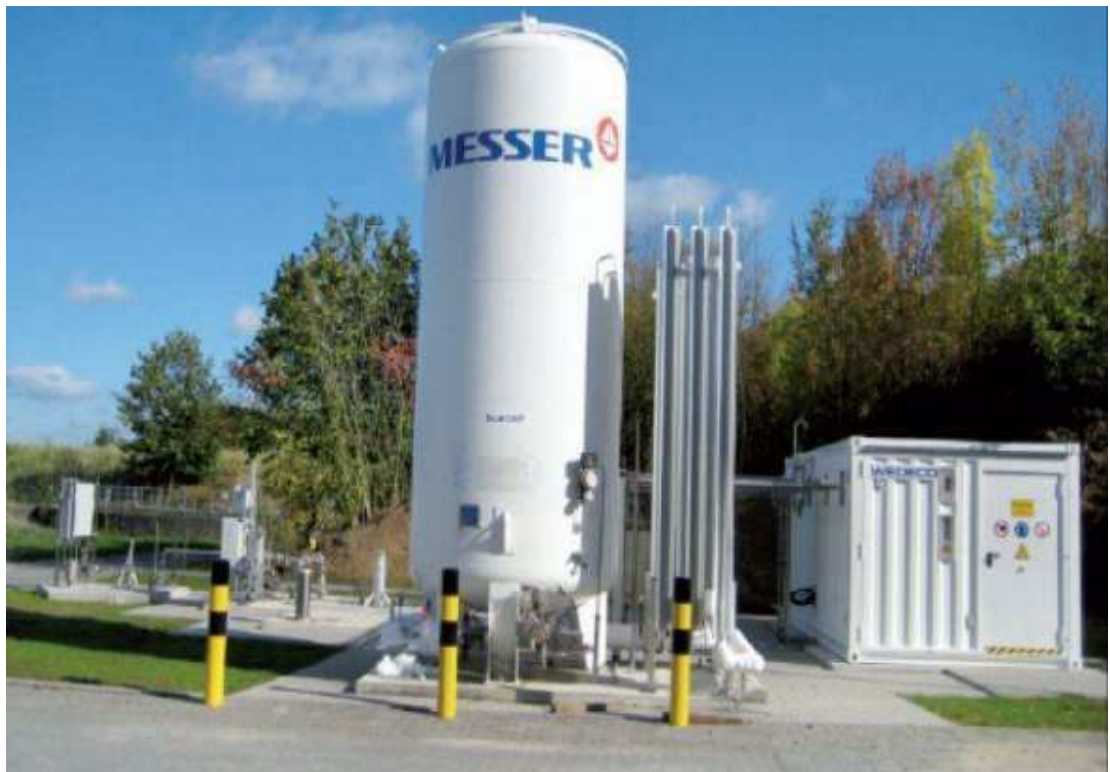
Abb. 6.1.1: Ozonanlage Bad Sassendorf in Containerbauweise ( Quelle: MKULNV, 2013
