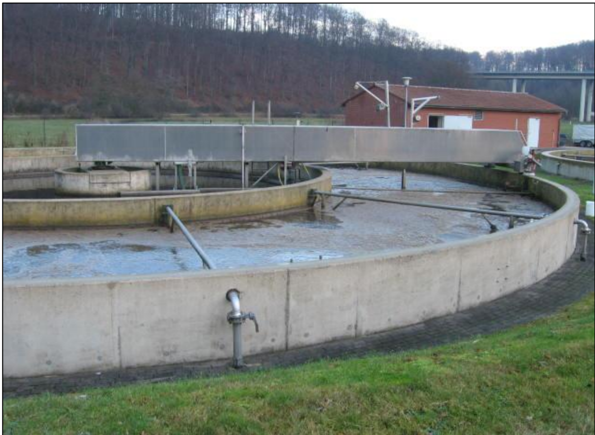
Abb. 2.2: Kombinationsbecken KA Grundsteinheim
