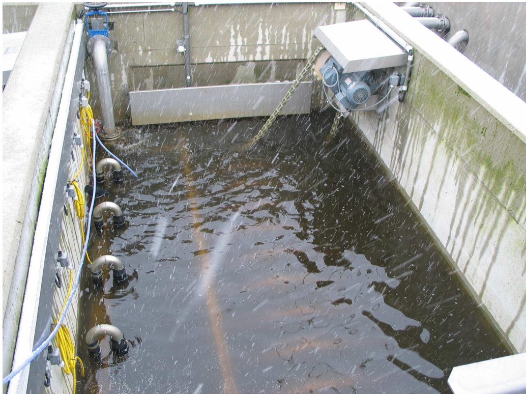
Bild 6-2: Tuchfiltrationseinheit im Klärwerk Oldenburg
