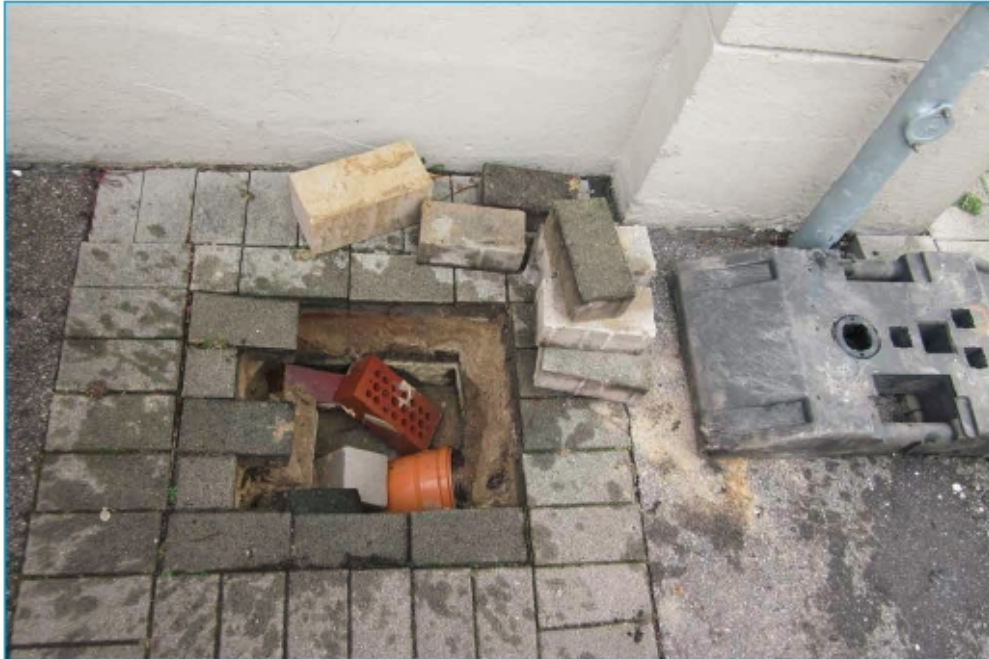
Bild 25: Straßeneinbruch im öffentlichen Verkehrsraum, Beispiel 1 [Foto: Stadt Gelsenkirchen]
