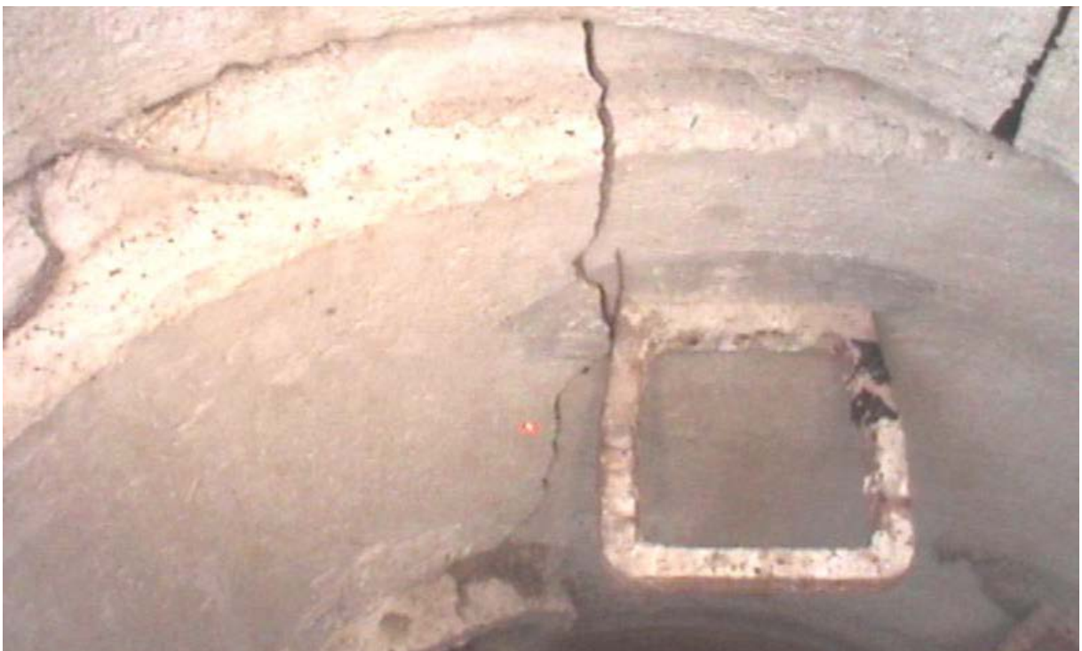
Bild 70: Rissbildung im Einsteigeschacht
