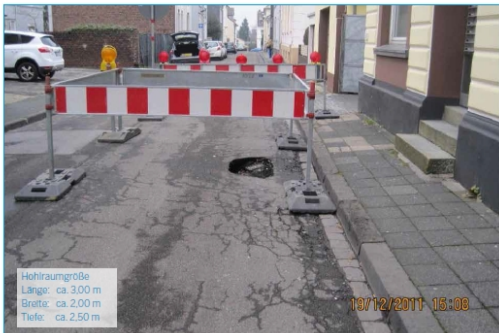
Bild 55: Straßeneinbruch mit unterirdischem Hohlraum in der Goldstraße [Foto: Technische Betriebe Solingen]
