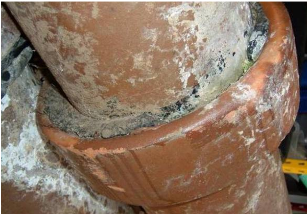
Bild 71: Schadhafte Dichtung aus Teerstrick und Vergussmasse an einer Rohrverbindung
