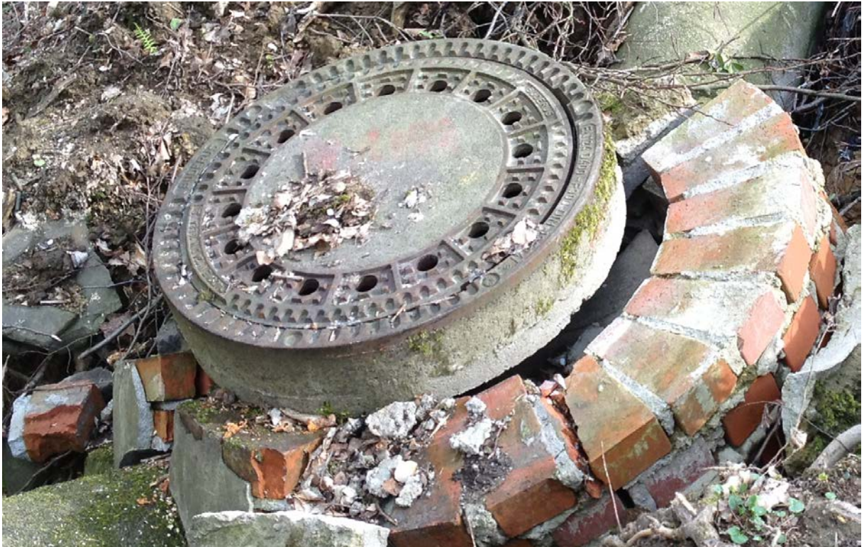
Bild 69: Eingestürzter und gebrochener Einsteigeschacht
