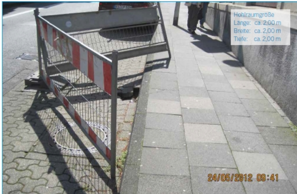
Bild 54: Straßeneinbruch mit unterirdischem Hohlraum in der Blumenstraße [Foto: Technische Betriebe Solingen]
