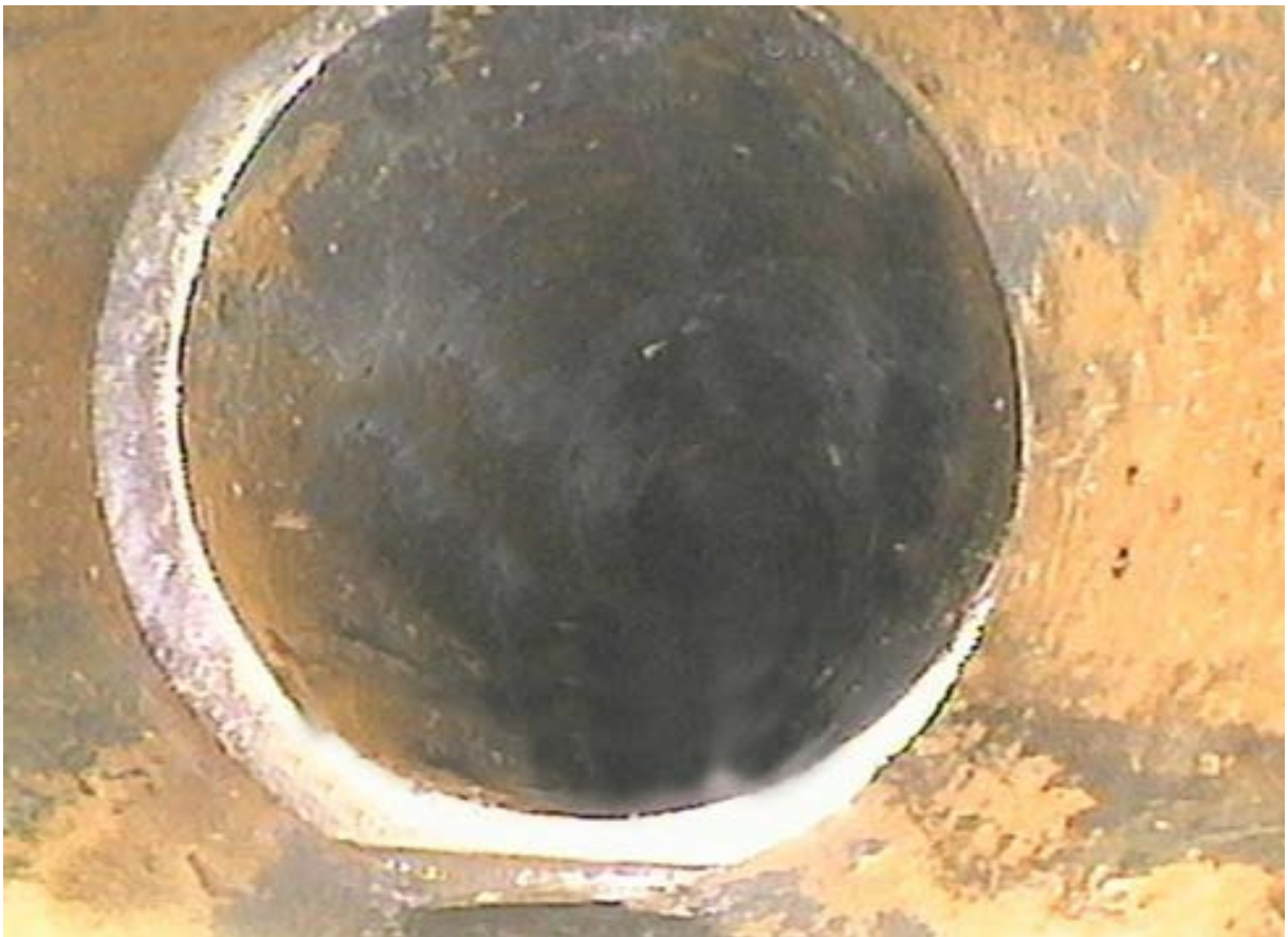
Bild 63: Verschobene Rohrverbindung BAJ (C1: B), Schadensklasse B nach DIN 1986-30 ( \geq 15 mm < 20 mm)
