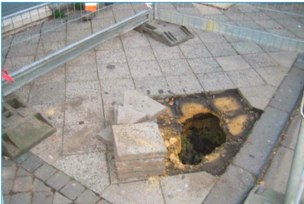
Bild 26: Straßeneinbruch im öffentlichen Verkehrsraum, Beispiel 2 [Foto: Stadt Gelsenkirchen]
