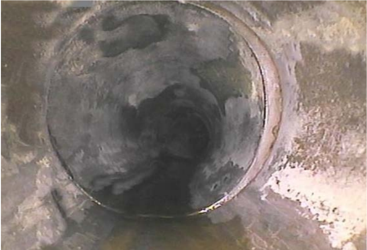
Bild 64: Verschobene Rohrverbindung BAJ (C1: B), Schadensklasse C nach DIN 1986-30 (< 15 mm)
