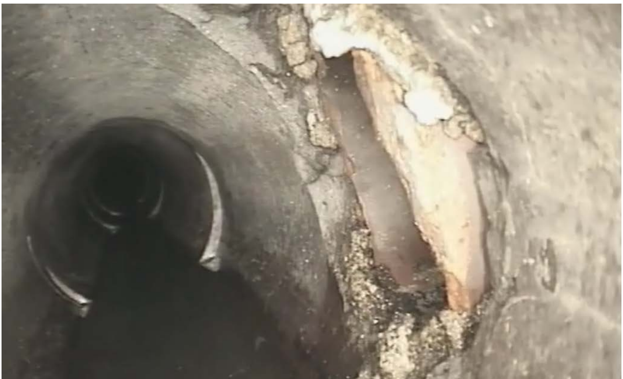
Bild 68: Schadhafter Anschluss der Abwasserleitung im Kanal
