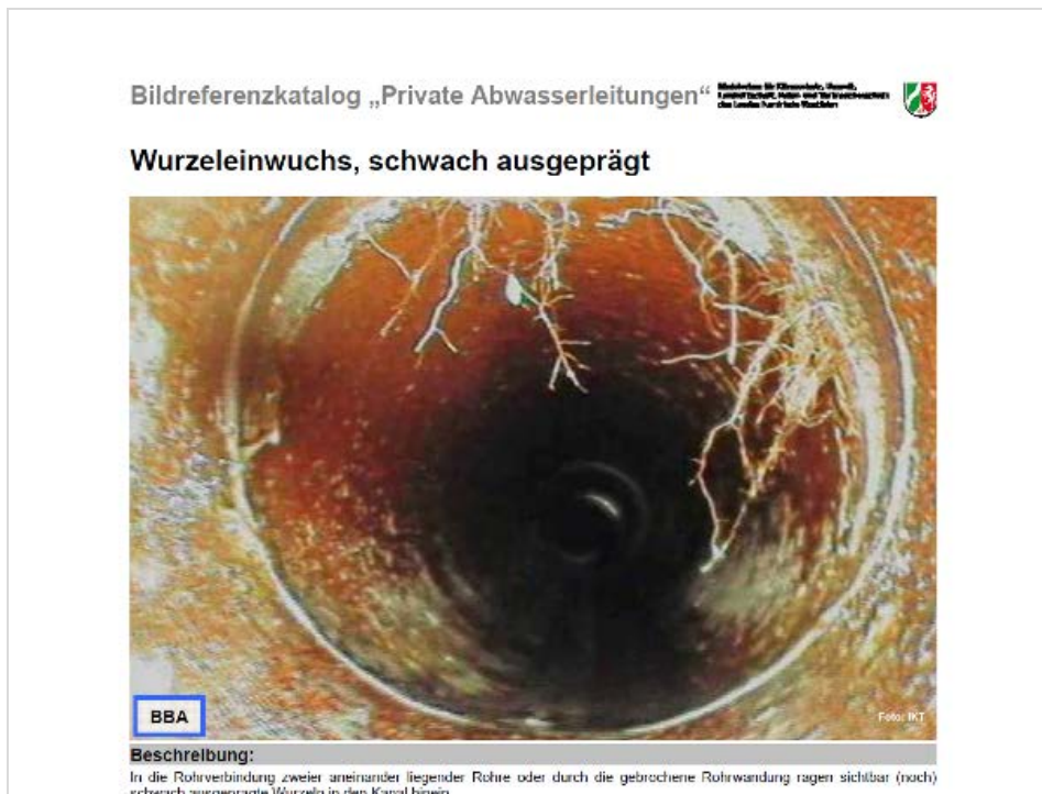
Bild 75: Bildreferenzkatalog „Private Abwasserleitungen“ aus Projektphase I (Stand: Mai 2011); Schaden, Bildreferenz, Beschreibung und Kodierung am Beispiel Wurzeleinwuchs, schwach ausgeprägt
