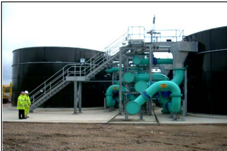
Abbildung 16: Großbritannien – Kläranlage Swindon, Einsatz von granulierter Aktivkohle
