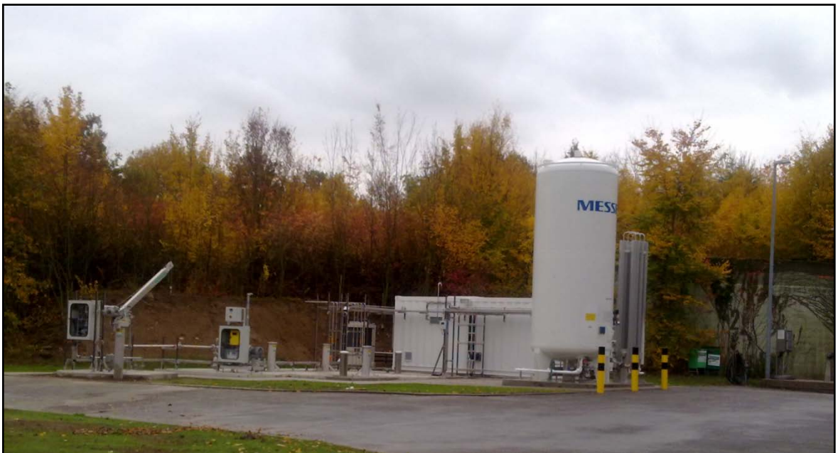
Abbildung 25: Kläranlage Bad Sassendorf - Ozonanlage mit Sauerstofftank
