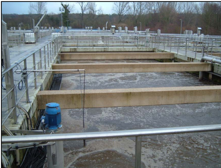
Abbildung 2: Belebungsbecken Zentralklärwerk Lage
