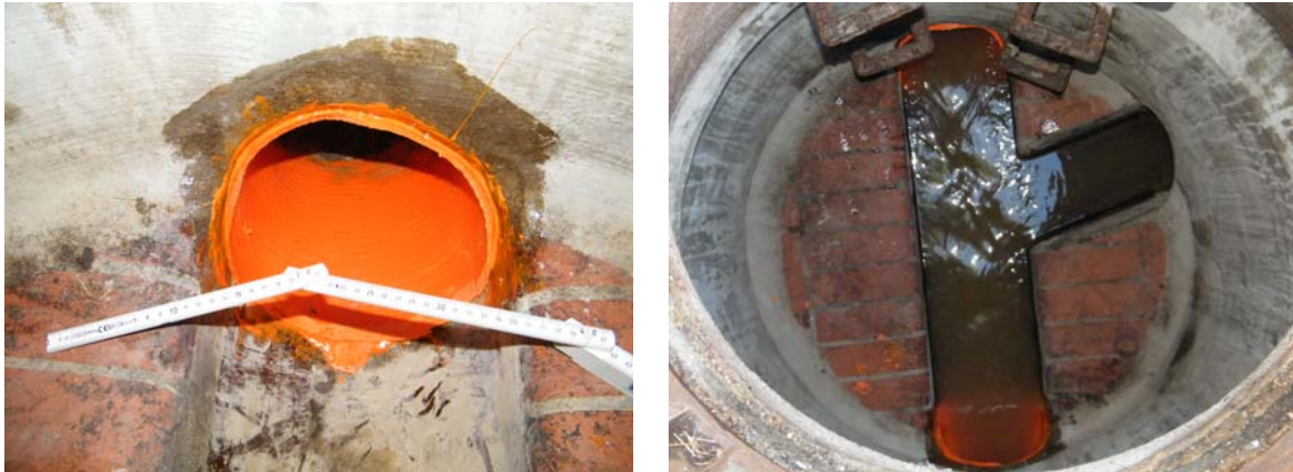
Bild 87 Ansicht der DEIV-Muffe unmittelbar vor (links) und nach der Inbetriebnahme des Schachtes (rechts)
