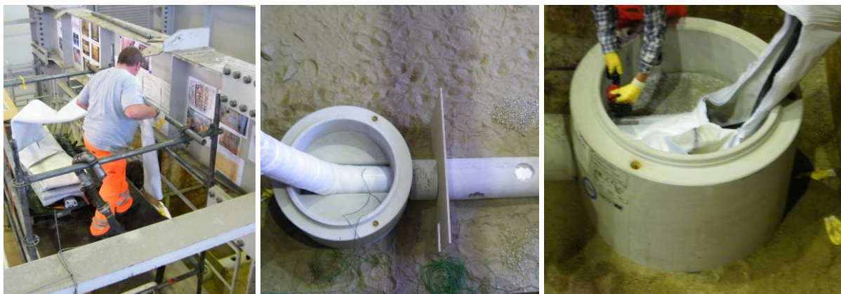
Bild 15 Einbringen des getränkten Nadelfilzschlauchs durch den Preliner in die Haltung (links) mit Wasserdruck (mittig), Entfernen von Liner-Reststücken aus dem Schacht (rechts)
