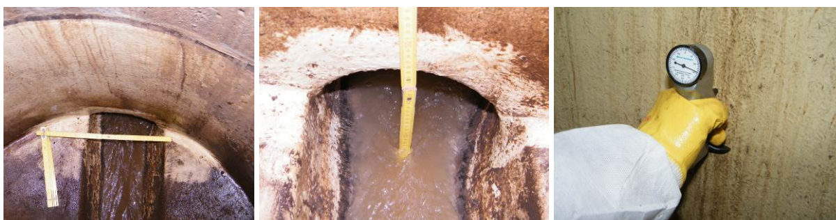
Bild 68 Beispiele für den Zustand der Auskleidungen nach zwei Jahren Betriebsbelastung: Ansicht des Anbindungsbereichs am Zulauf (links) und als Detailaufnahme (mittig); Beispiel für das Messen der Barcol-Härte (rechts) zum Vergleich
