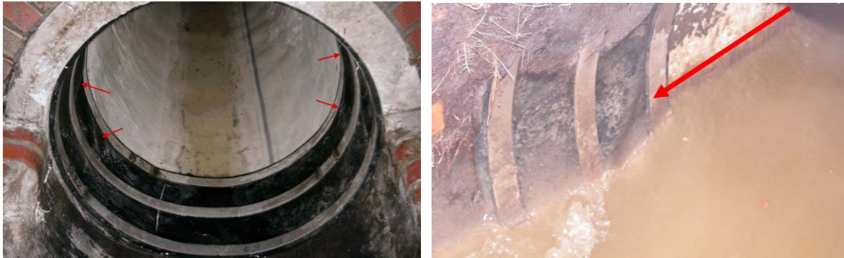
Bild 89 Ansicht der Manschette nach Einbau mit geringfügigen Deformationen (vgl. rote Pfeile, links) und Kontrolle des Zustands etwa 8 Jahre nach Einbau mit wieder erkennbarer, geringfügiger Deformation (roter Pfeil, rechts)
