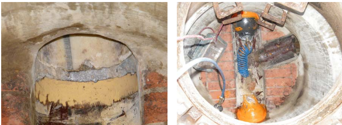
Bild 86 Angerautes Gerinne aus Steinzeug, sauber und trocken (links); eingesetzte und mit Packern aufgestellte Muffen im Zu- und Ablauf (rechts)
