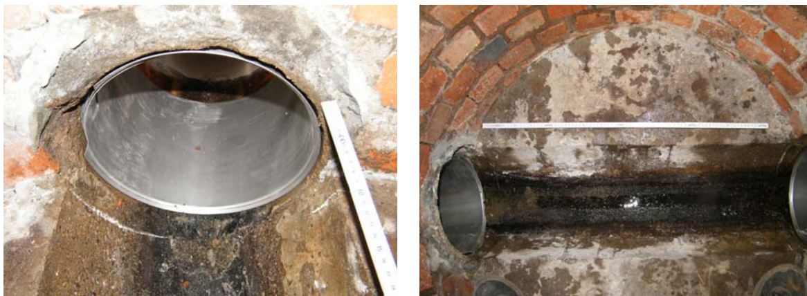
Bild 92 Eingebaute Liner-End-Manschette mit nur sichtbarer Edelstahlhülse (links) in der Detailansicht; sanierte Liner-Schacht-Anbindungen im Zu- und Ablauf (rechts) unmittelbar vor Inbetriebnahme
