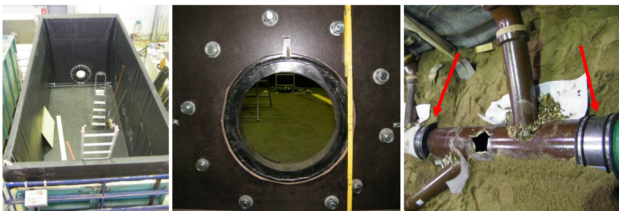
Bild 27 Abdichtung des Containers mittels Teichfolie (links), Öffnung in der Containerwand zur Rohrdurchführung (mittig), Verbindung der Beton-Steinzeug-PVC-Rohrstücke mittels Adapterkupplungen (rote Pfeile, rechts)
