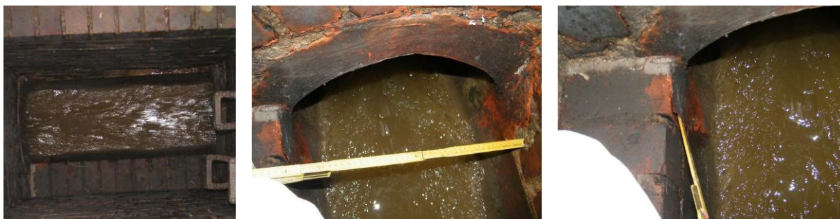
Bild 78 Blick in den Schacht (links) mit Lineranschlüssen am Ablauf links, Detailansicht des Ablaufs (mittig) und Materialablösung am Klinkerstein der Berme (rechts)
