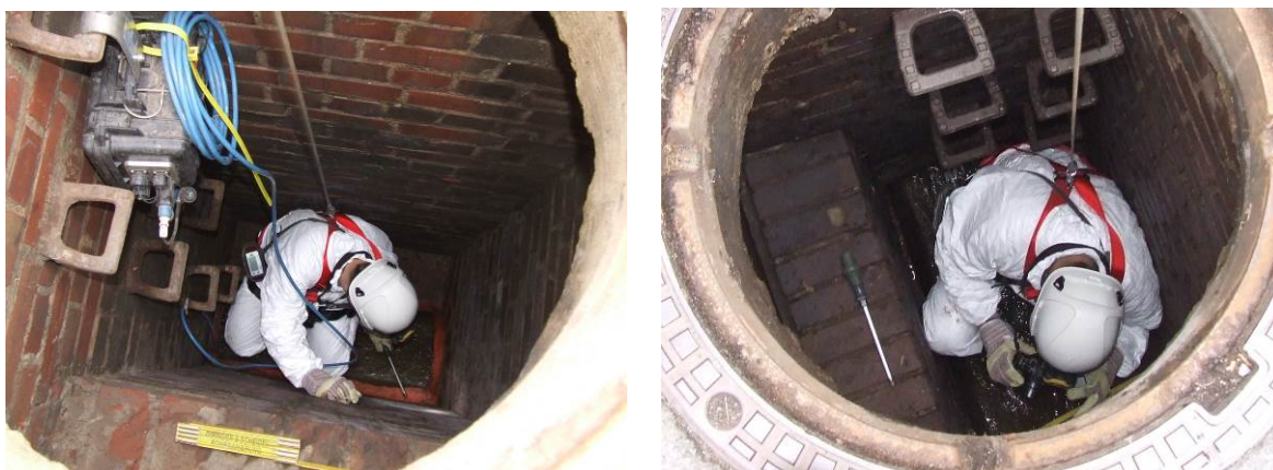
Bild 80 Abklopfen des Harzes mit einem Schraubendreher (links) und Dokumentieren des Sanierungszustandes (rechts)
