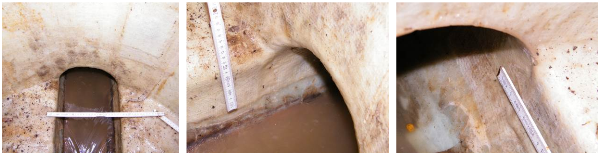
Bild 70 Beispiele für den Zustand der Auskleidungen nach ca. drei Jahren Betriebsbelastung: Ansicht des Anbindungsbereichs am Zulauf (links) und als Detailaufnahme (mittig und rechts)
