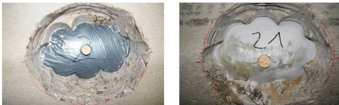
Bild 16 Beispiel für in den GFK- (links) und Nadelfilzliner (rechts) eingesetzte Korken zur Kennzeichnung von Innen
