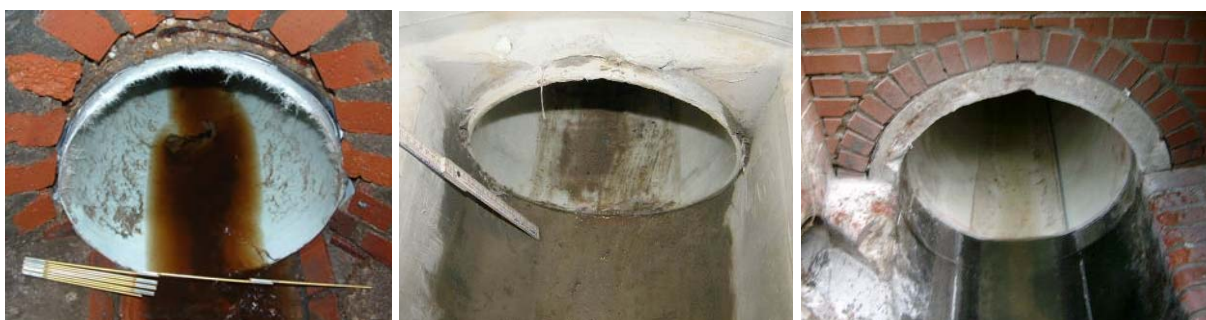
Bild 71 Beispiele für die Lage des Liners im Rohranbindebereich für weitergehende Anbindungsmaßnahmen, aus dem Rohr heraus stehend (links und mittig) und bereits zurückgeschnitten innerhalb des Rohres (rechts)
