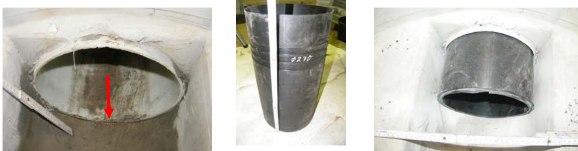
Bild 93 Undichtigkeit in Linersohle (vgl. roter Pfeil, links), Anpassen der Stüpe auf den vorhandenen Durchmesser (mittig), Stüpe nach Einschieben in den Liner und vor dem Verschweißen mit der Schacht- und Gerinneauskleidung aus PE-HD (rechts)
