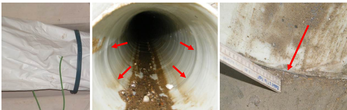
Bild 72 Blaues Quellband um Preliner bei Einbau (links) und seine ungefähre Lage im Ringspalt zwischen Liner und Altrohr (mittig, rote Pfeile); geringfügiger Wassereindrang trotz eingelegtem Quellband (rechts, roter Pfeil)
