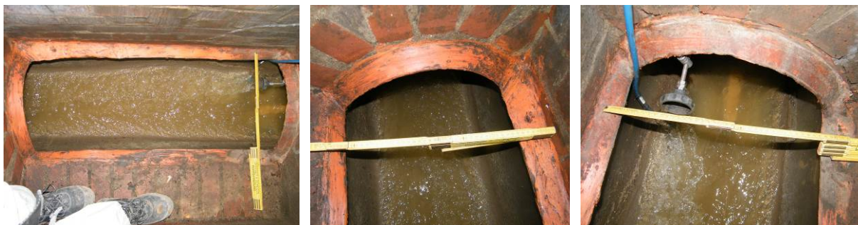
Bild 81 Nachuntersuchung des mit Harz 8 angebondenen Liners im Schachtgerinne (links) und Detailaufnahmen der Rohranschlussbereiche (mittig und rechts)
