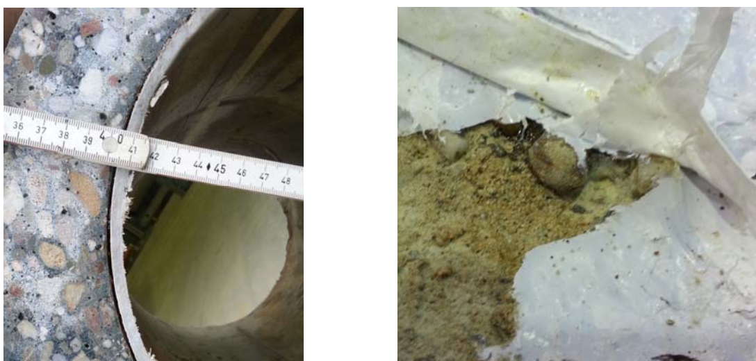
Bild 115 Lokaler Ringspalt gegenüber der Einbeulung (links) und Sandablagerungen (Korndurchmesser 5 mm, rechts), welche ein Aufreißen des Preliners und lokale Deformationen zur Folge hatten
