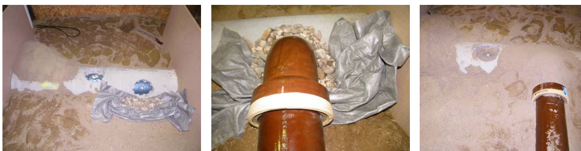
Bild 20 Schadensbild 3: Kies auf Vlies vor Auflegen der Rohrverbindung (links), Auffüllen der Kiespackung (mittig) und Überschütten des Rohranschlussbereichs mit Kies-Sand (rechts)
