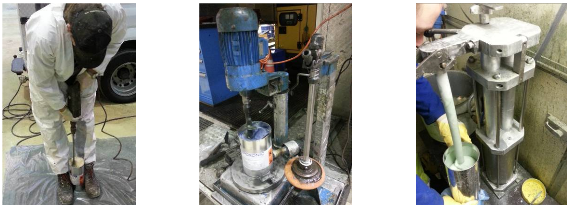
Bild 44 Mischen der Komponenten A und B des Verpressmaterials von Hand (links) und mittels Rührwerk (mittig) sowie Statkmischer (rechts)
