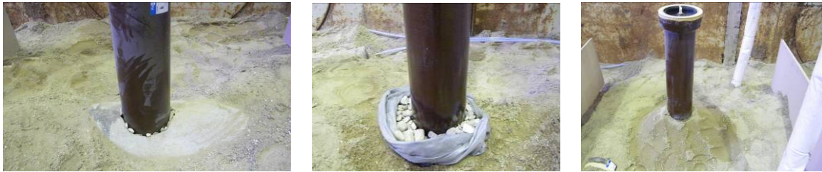
Bild 21 Schadensbild 2: Einsetzen des vorbereiteten Steinzeugrohrs in das Betonrohr (links), Auffüllen der Schadstelle mit Kies und Vlies (mittig) und Überschütten des Rohranschlussbereichs mit Kies-Sand (rechts)
