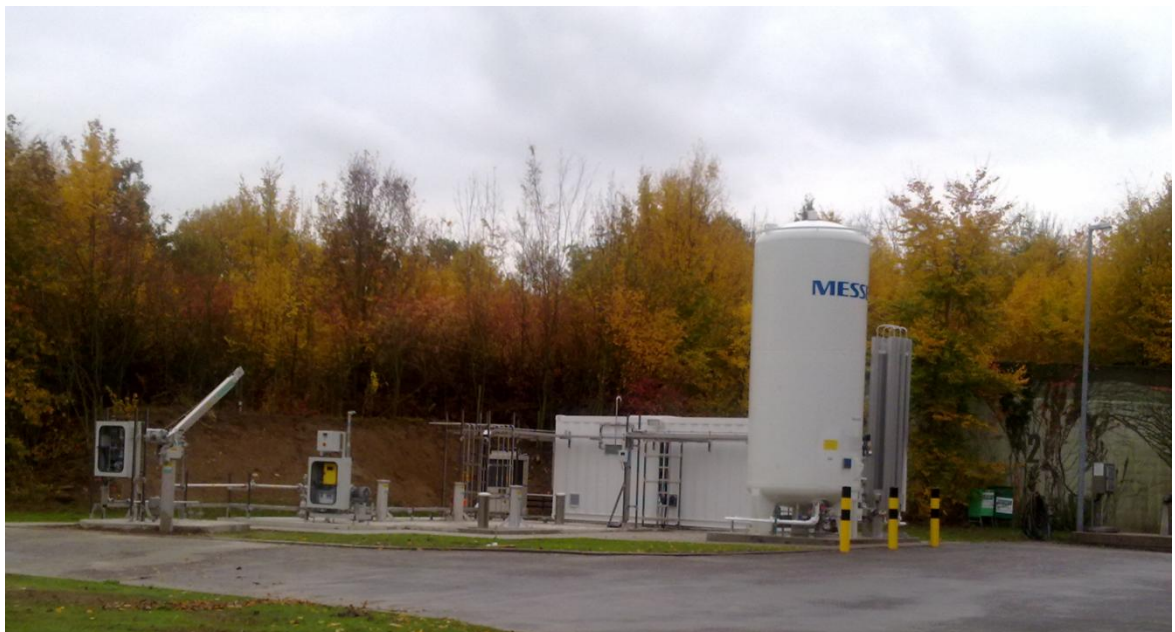
Abbildung 22: Kläranlage Bad Sassendorf – Ozonanlage mit Sauerstofftank
