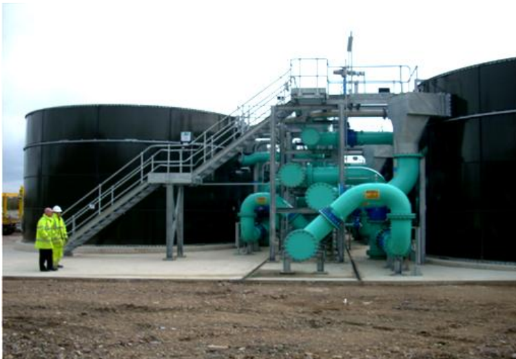
Abbildung 13: Großbritannien – Kläranlage Swindon, Einsatz von granulierter Aktivkohle
