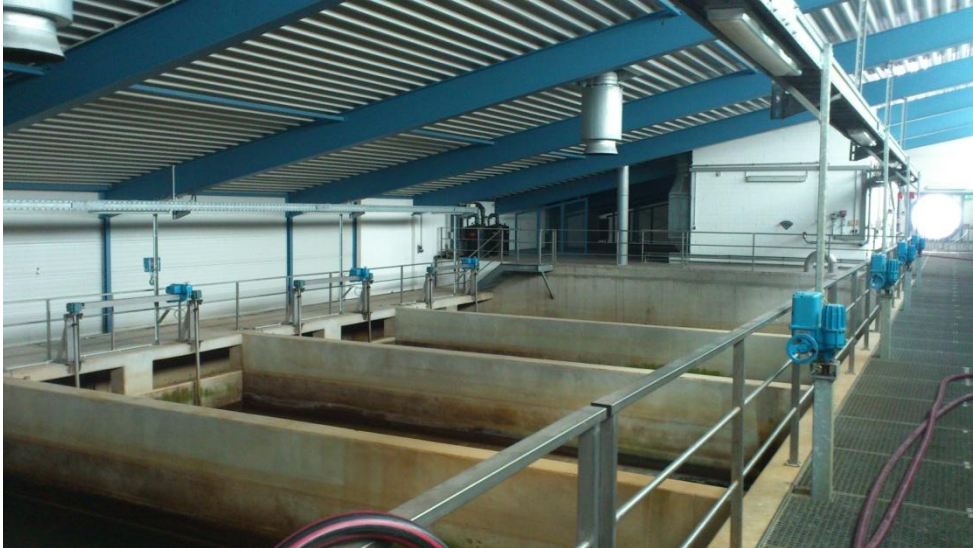
Abbildung 3: Flockungsfiltration Kläranlage Lemgo
