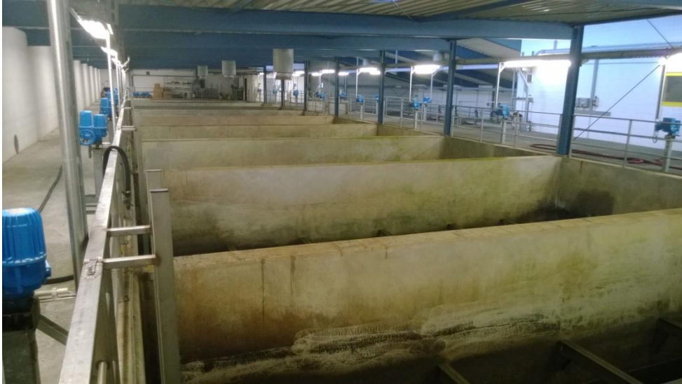
Abbildung 2: Nitri- und Denitrifikationsfilter Kläranlage Lemgo
