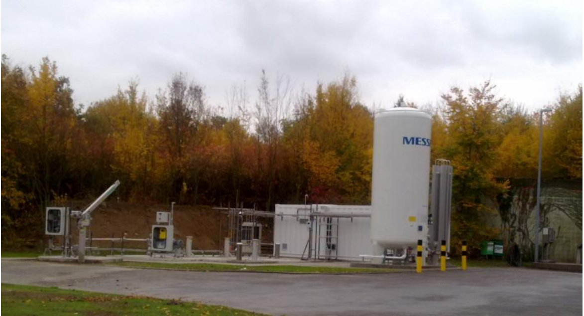
Abbildung 19: Kläranlage Bad Sassendorf – Ozonanlage mit Sauerstofftank
