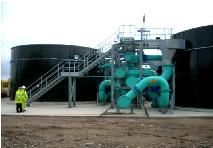
Abbildung 12: Großbritannien – Kläranlage Swindon, Einsatz von granulierter Aktivkohle
