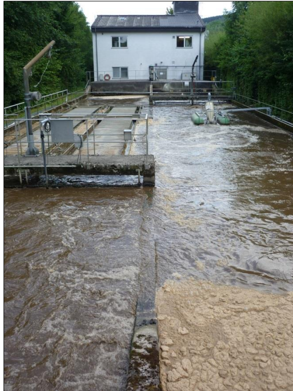
Abb. 19: Simultanes Belebungsbecken mit Lamellenschrägklärer
