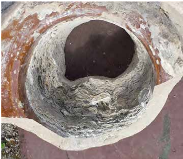
Abbildung 73: Durch eine Baumaßnahme schichtenweise zugesetztes Steinzeugrohr
