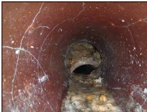
Abbildung 197: Versackung/ Muffenversatz (Backnang, 2014)
