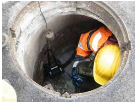
Abbildung 109: Ablagerungskontrolle mit Kanalspiegel (van Laak, 2014a)
