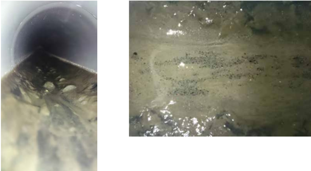
Abbildung 100: Links: Blick in das Versuchsrohr zum Ende der Versuchsreihe 3 mit Ansammlung von Ablagerungen. Rechts: Draufsicht auf die entstandenen Ablagerungen, mineralisches Sediment in der Mitte des Rohres und Sielhaut an den Rändern.
