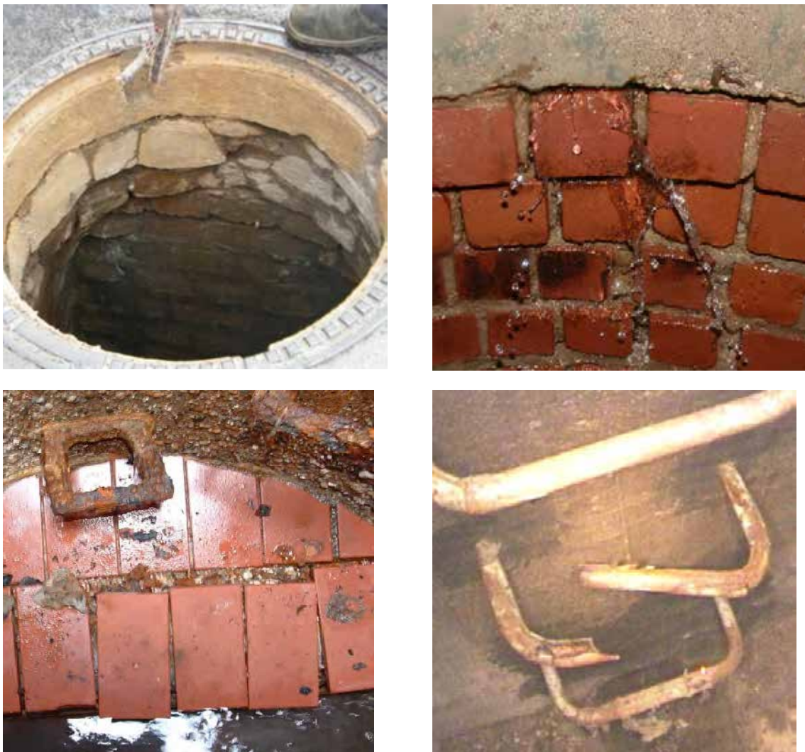
Abbildung 118: Direkt erkennbare typische Schäden an Abwasserschächten: brüchiger Schachtkörper(links oben), undichter Schachtkörper (rechts oben), schadhafte Bankett (links unten), defekte Steigeisen (rechts unten)
