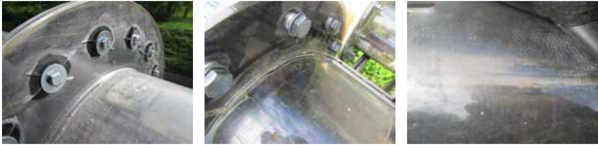
Abbildung 46: Die drei Abbildungen zeigen deutliche Abnutzungserscheinungen an den drei Plexiglasrohren. Links und Mitte: Risse im Material, welche zu Undichtigkeiten im System führten. Rechts: Haarrisse und Riefen im Material, wodurch die Ablagerungen nur schwer zu erkennen waren
