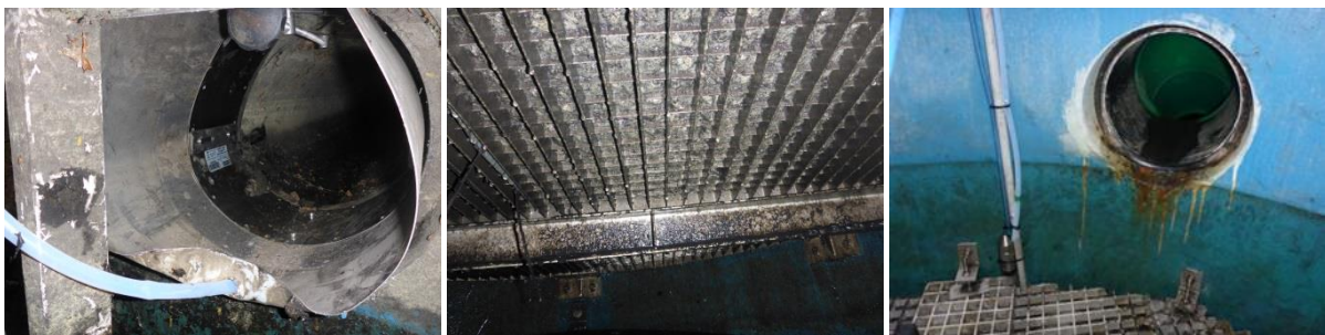
Abbildung 116: Installation der Probenehmerschläuche in Zulauf, unter der Filterstufe und vor dem Ablauf (v. l. n. r)
