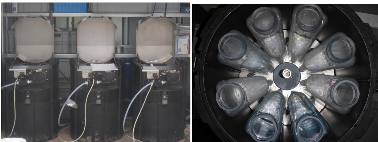
Abbildung 82: Probenehmer für Zulauf-, Filter- und Ablaufproben
