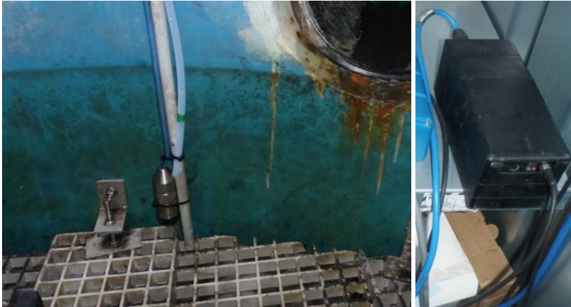
Abbildung 113: Installierte Höhenstandsmessung (links) (hier am Ablauf über dem Filter) und DFÜ (rechts)
