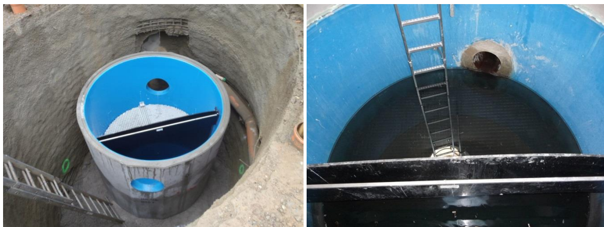
Abbildung 64: System FiltaPex Standard DN 2200 in Betonausführung, FiltaPex Standard BE-2200 (hier: Ronsdorfer Straße in Wuppertal, Inbetriebnahme 02/2012).
