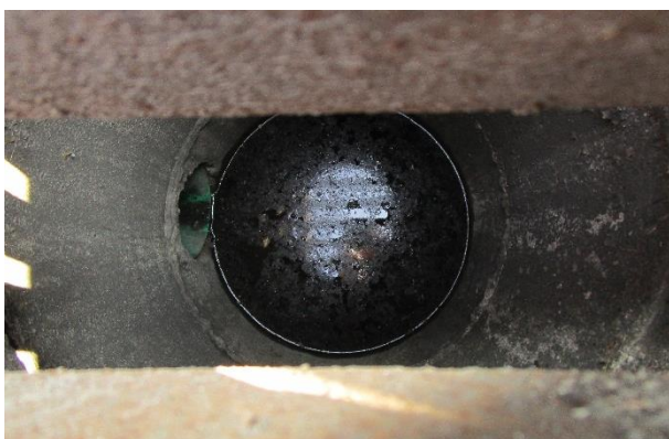
Abbildung 131: Straßenablauf mit Nassschlammfang am Standort Mönchengladbach
