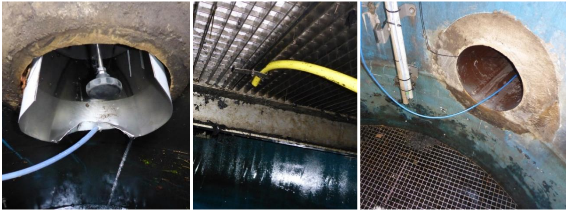
Abbildung 83: Probenahme Zulauf (links), vor Filter (Mitte) und Ablauf (rechts) Filter Ronsdorfer Str.
