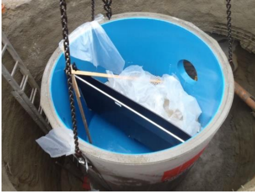
Abbildung 76: Filterschacht Standort Wuppertal, Ronsdorfer Straße
