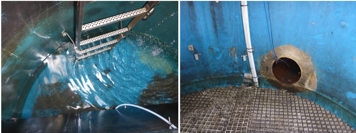
Abbildung 79: Höhenstandsmessung Zu- und Ablaufseite
