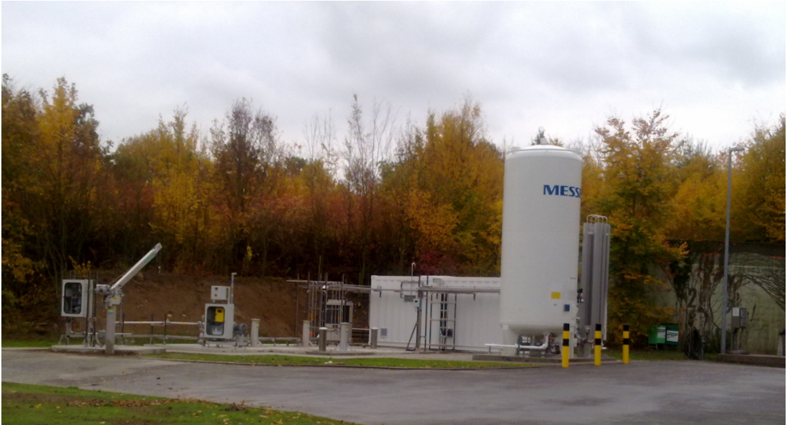
Abbildung 22: Kläranlage Bad Sassendorf – Ozonanlage mit Sauerstofftank
