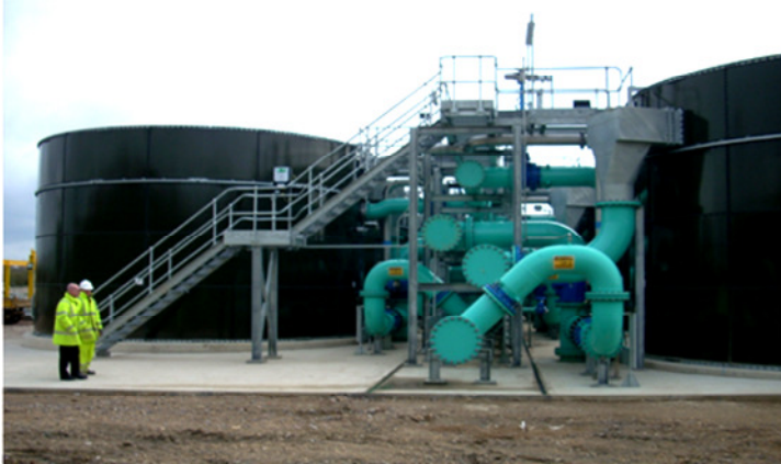
Abbildung 15: Großbritannien – Kläranlage Swindon, Einsatz von granulierter Aktivkohle
