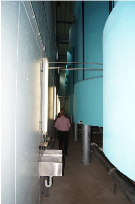
Abbildung 5: Filter linke Wandseite
