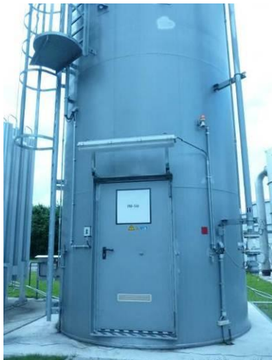
Abbildung 4-5: PAK-Speichersilo mit Dosiereinrichtung KA Schwerte
