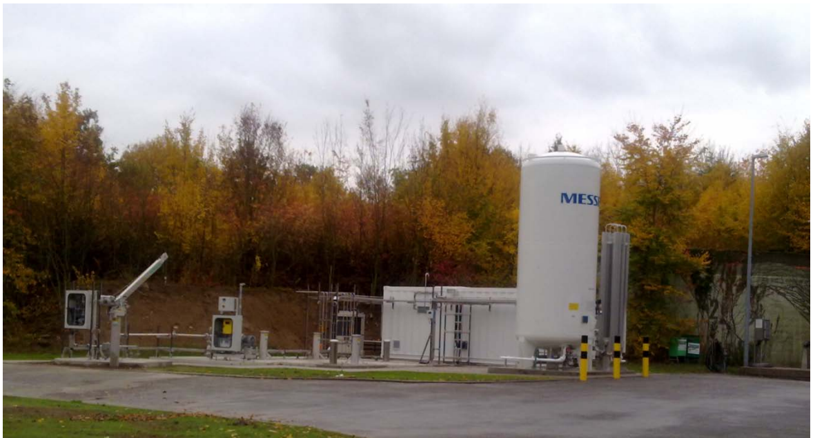
Abbildung 21: Kläranlage Bad Sassendorf – Ozonanlage mit Sauerstofftank
