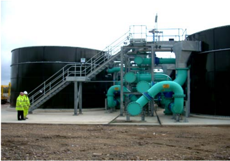
Abbildung 12: Großbritannien – Kläranlage Swindon, Einsatz von granulierter Aktivkohle
