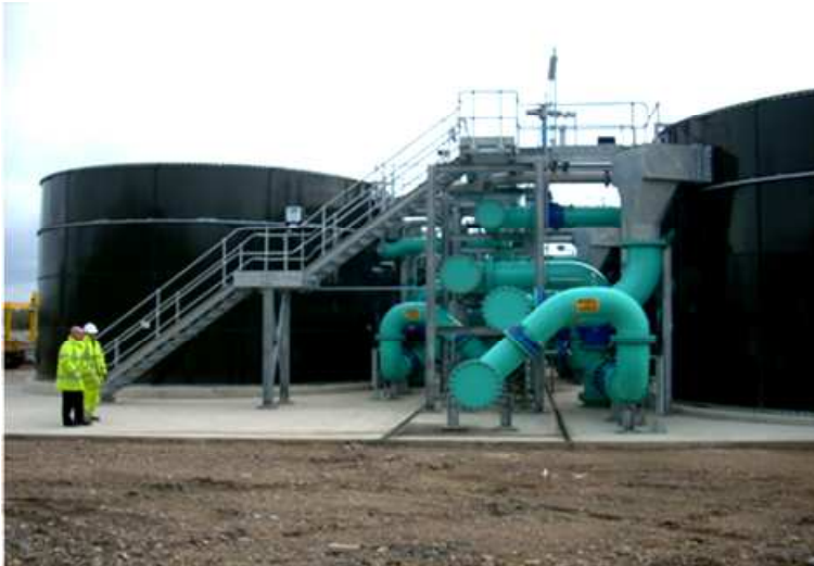
Abbildung 11: Großbritannien – Kläranlage Swindon, Einsatz von granulierter Aktivkohle
