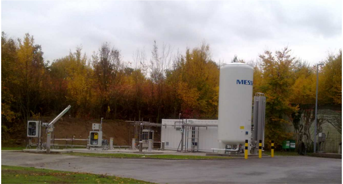
Abbildung 20: Kläranlage Bad Sassendorf – Ozonanlage mit Sauerstofftank
