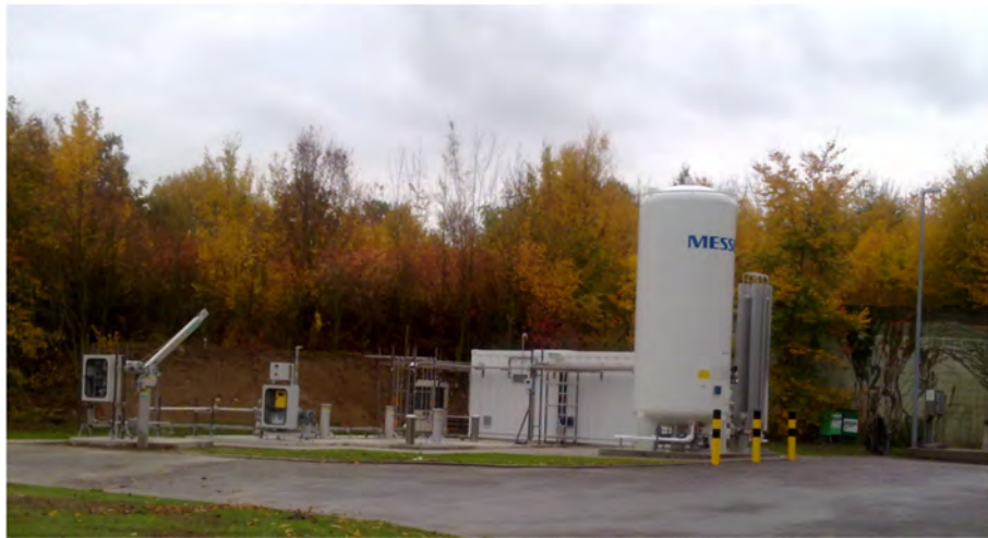
Abbildung 11: Ozonanlage mit Sauerstofftank der Kläranlage Bad Sassendorf
