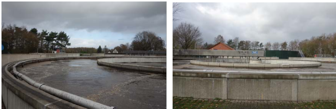
Bild 1: Belebungsbecken, innen liegende Nachklärung (links, rechts)
