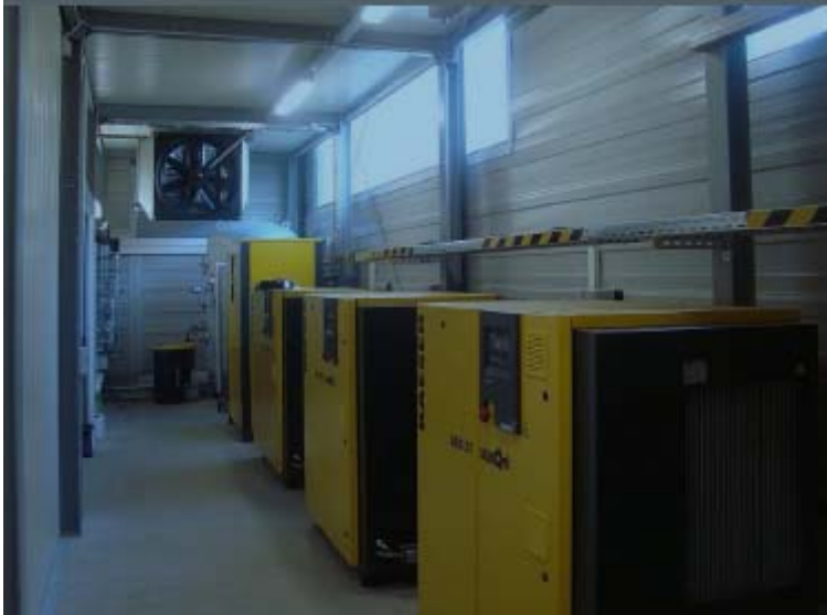
Bild 35: Kompressorstation (Quelle: Fa. Nordic Water)
