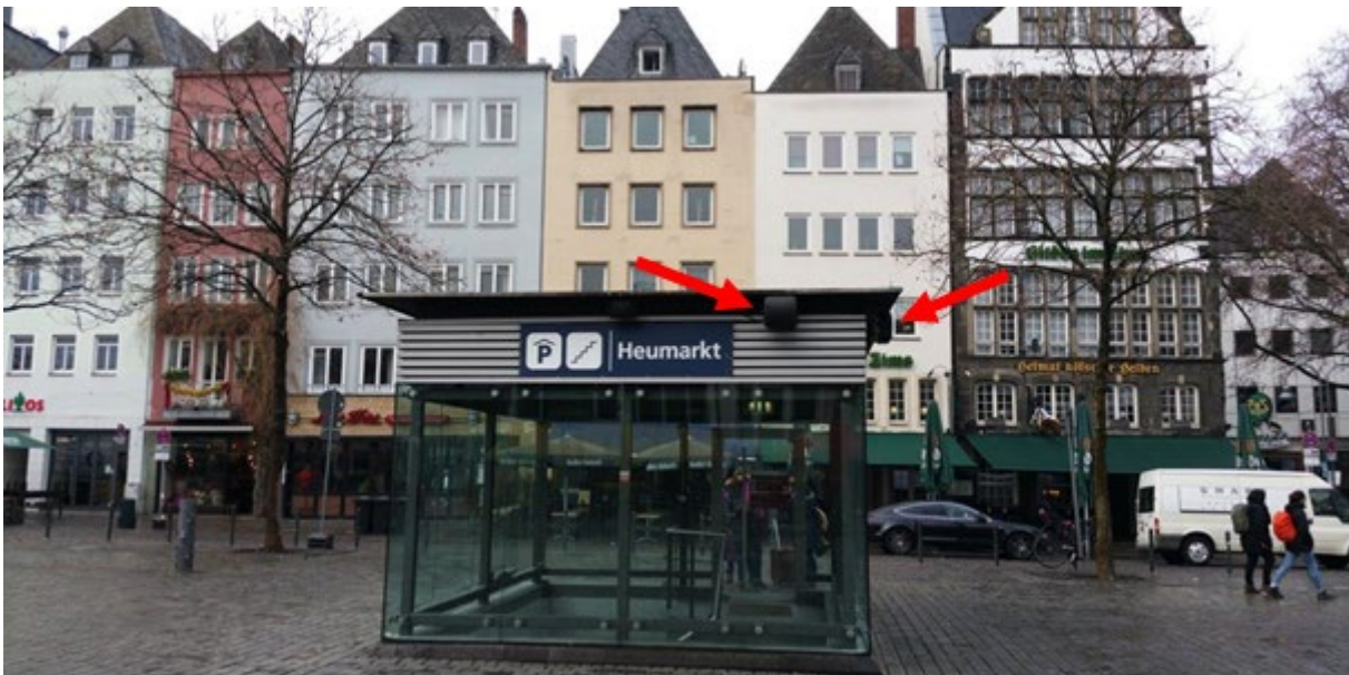
Abbildung 4.4: Standort 2 (Blick von Osten auf den Eingang zur Tiefgarage): Auf dem Foto zu sehen sind die Antennen der Kleinzellenanlage für den Ost- und den Nordsektor (Commscope, Typ CMAX-DM60-CPUSEi53).
