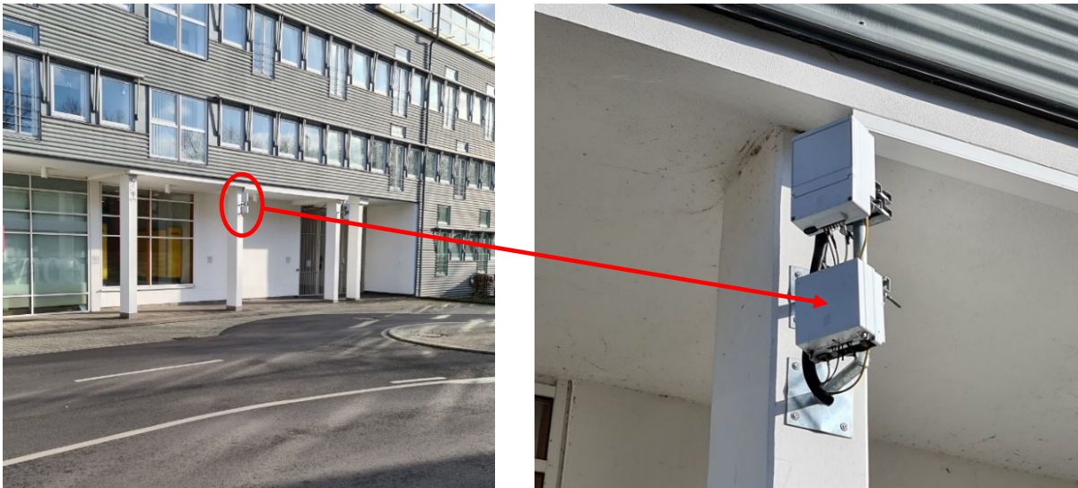
Abbildung 4.1: Standort 1: Antenne der Kleinzellenanlage (Ericsson, Typ 6524)
