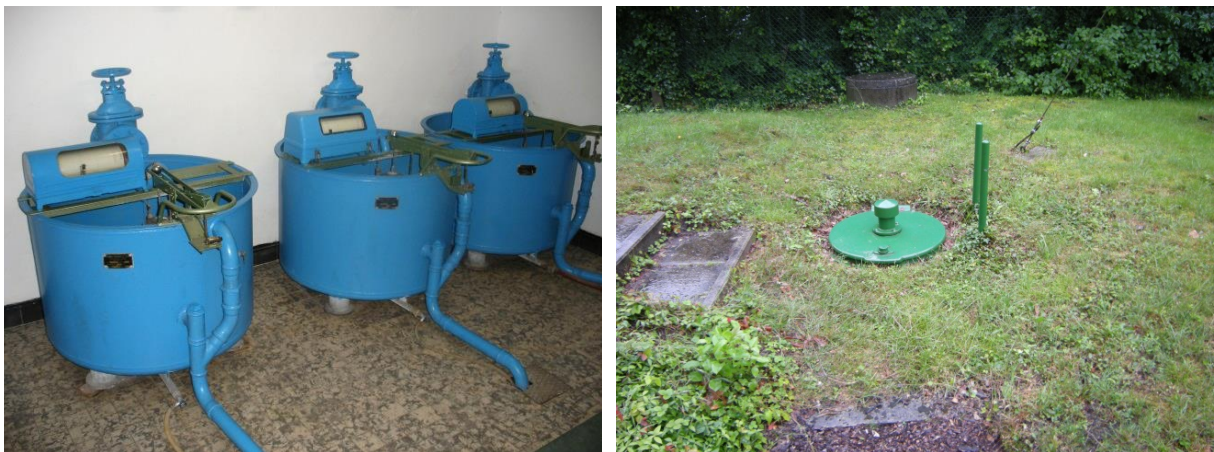
Abbildung 6: Messkeller mit Auffangbecken für Sickerwasser (links), Versickerungsschacht (rechts)
