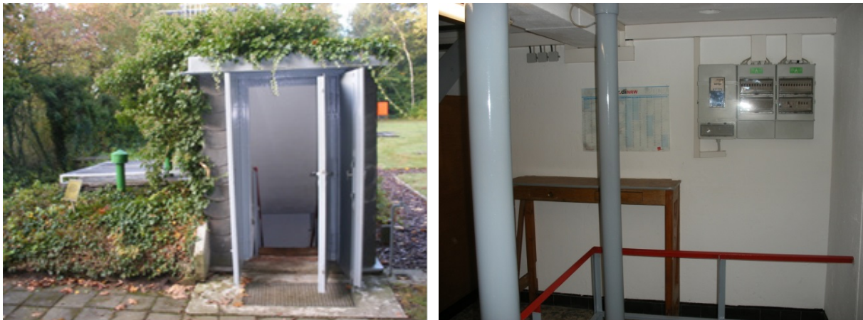
Abbildung 5: Eingang zum Messkeller (links), Sicherungen im Lysimeterkeller (rechts)
