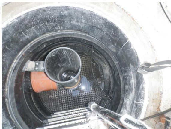
Bild 2 Blick in den Filterschacht FiltaPex® KE-1250 an der Ronsdorfer Straße in Wuppertal
