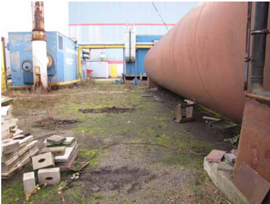
Probenahmepunkte 5 und 6: Brachflächen im Hofbereich bei den Tank- und Versorgungsanlagen; in Teilbereichen verwitterte Betondeckschicht unterliegend
