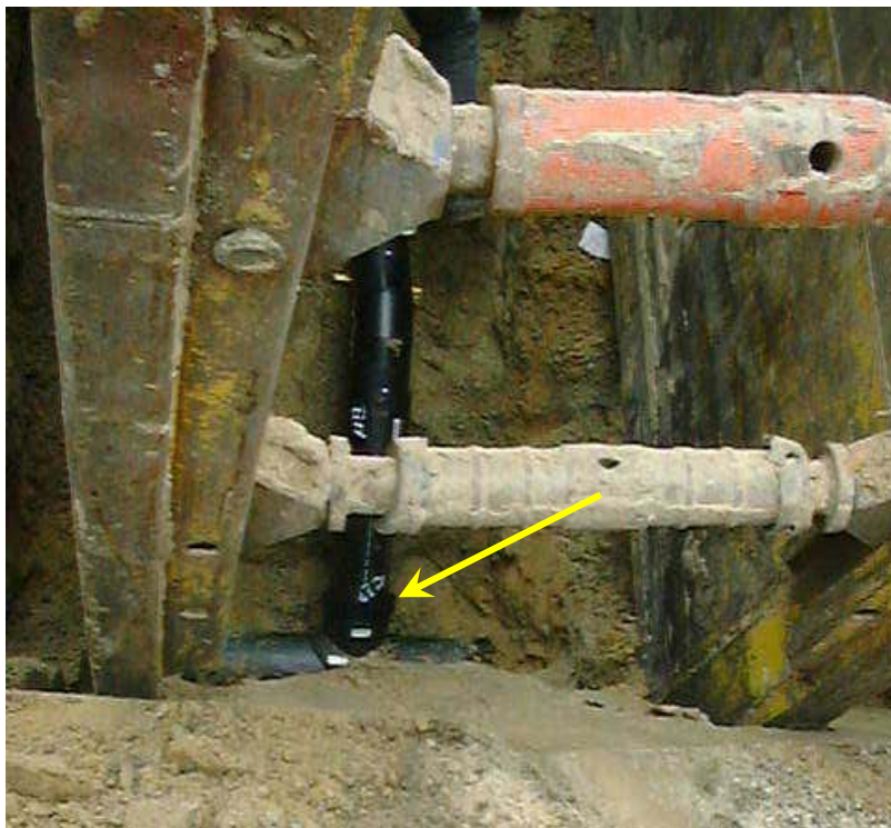
Abbildung 51: Hausanschluss mit aufgesteckten Datenträger (Pfeil) [FITR]
