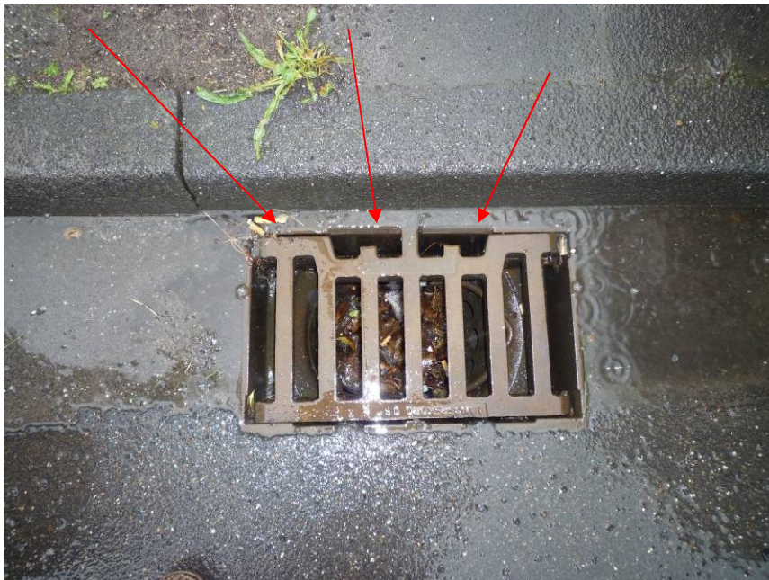
Abbildung 60: Zufuss zum Filtersack im Straßenablauf PL-07:
