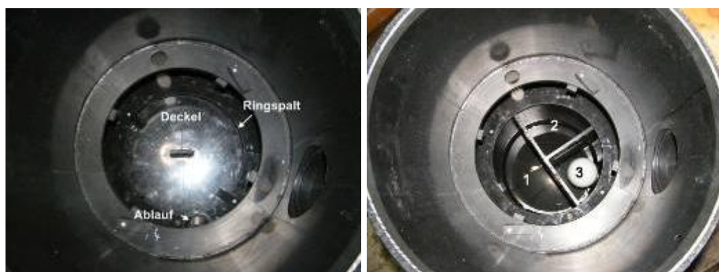
Abbildung 17: Links: Blick in die mittlere Kammer (Nassschlammfang) mit dem Ablauf (Steigrohr) zur unteren Kammer; Rechts: Untere Kammer mit drei Teilkammern 1,2 und 3, Kammer 3 – seitlicher Auslauf (Krümmer) mit Ventilkugel zur Leichtstoffabscheidung.
