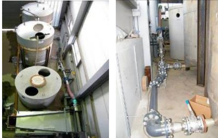
Abbildung 2: Links: Zwei Edelstahltanks mit jeweils 10 m 3 Fassungsvermögen als Vorlagebehälter (im Hintergrund), Rechts: Zulaufleitung aus Kunststoff zur beflutbaren Fläche.
