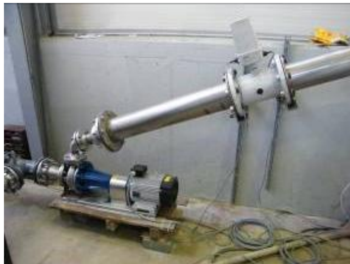
Abbildung 3: Kreiselpumpe mit einer Leistung von bis zu 20 l/s mit einer Edelstahlleitung DN 150 und MID DN 150 zur Regelung der Durchflussmengen ab 3 l/s.
