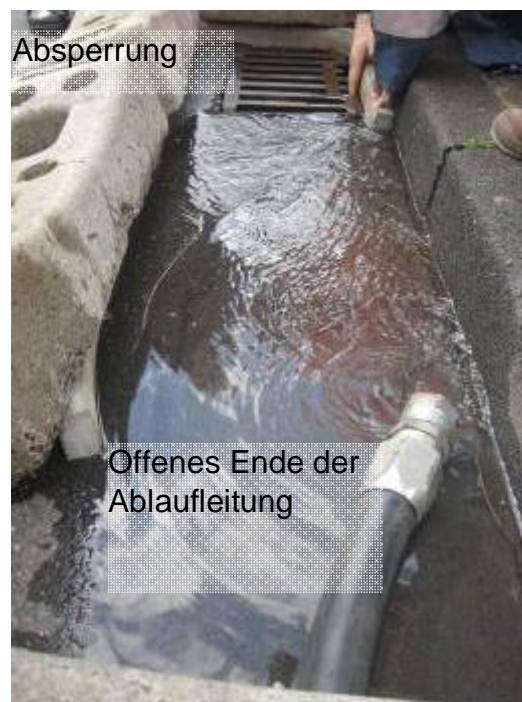
Abbildung 55: Beschickung eines Straßenablaufs über den Rinnstein mit einem definierten Volumenstrom zur Bestimmung der hydraulischen Leistungsfähigkeit einer Niederschlagswasserbehandlungsanlage
