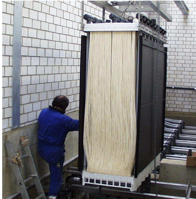
Abb. 1-1: Installation der Membranmodule (März 1999)
