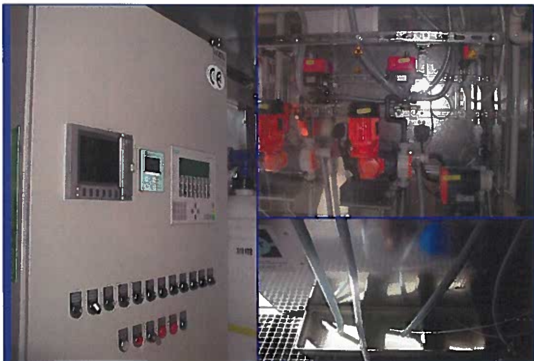
Abb. 4-8: Neue externe Waschzelle – Steuer-, Maschinentechnik
