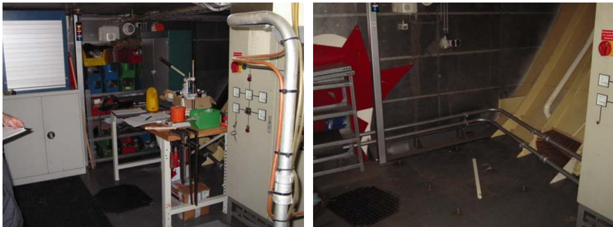
Abbildung 2: Aufstellplatz der Pilotanlage im vorderen Maschinenraum der MS Asbach
