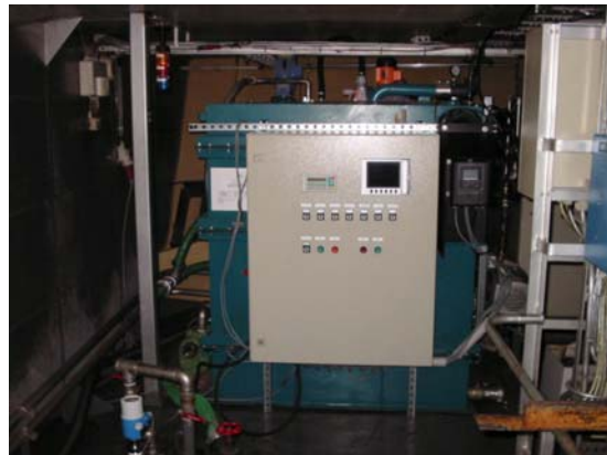
Pilotanlage Earth Tech Umwelttechnik GmbH
