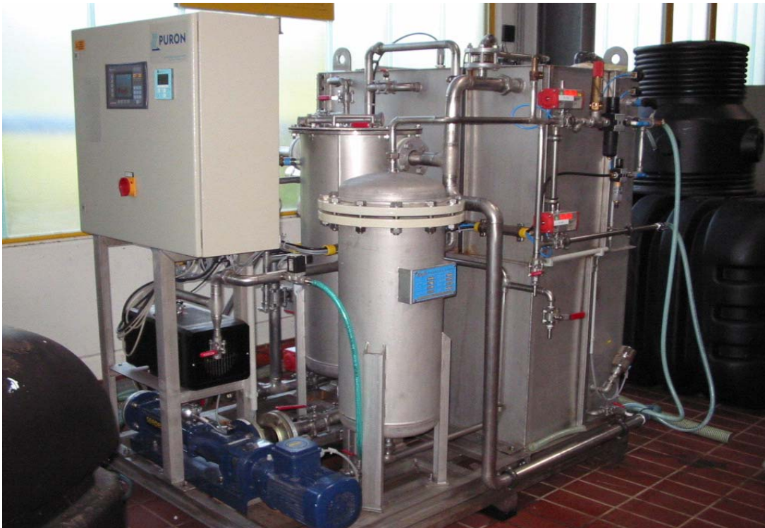
Abbildung 9: Pilotanlage der Firma Puron AG
