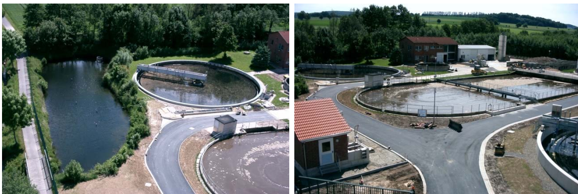
Abbildung 3-3: Nachklärbecken 2 und Teichanlage (Danjes 2002)
