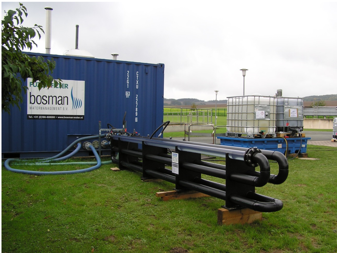
Abbildung 4-9: Testcontainer mit Rohrflockulator und Vorratsbehältern für PAC - Suspension und Fällmittel (Foto: Bosman Watermanagement GmbH)
