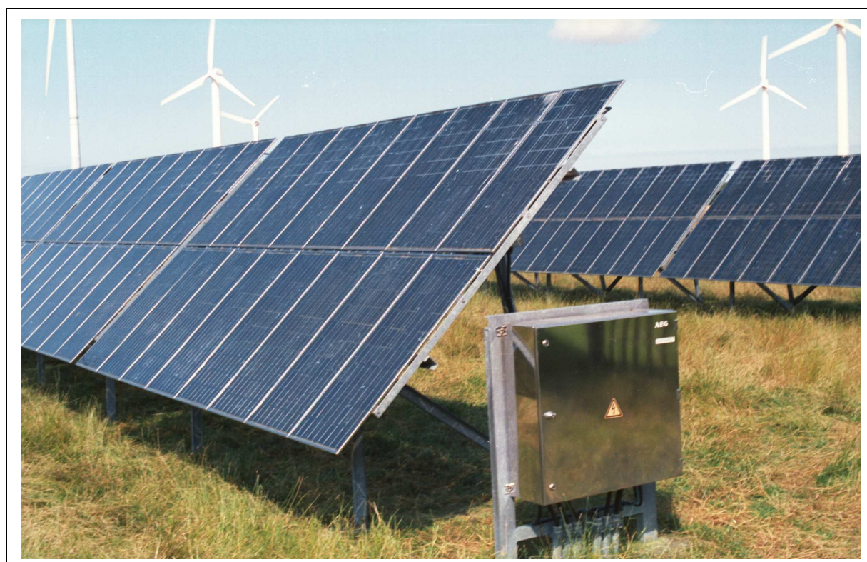
Abbildung 25: Photovoltaikanlage der Kläranlage Burg auf Fehmarn
