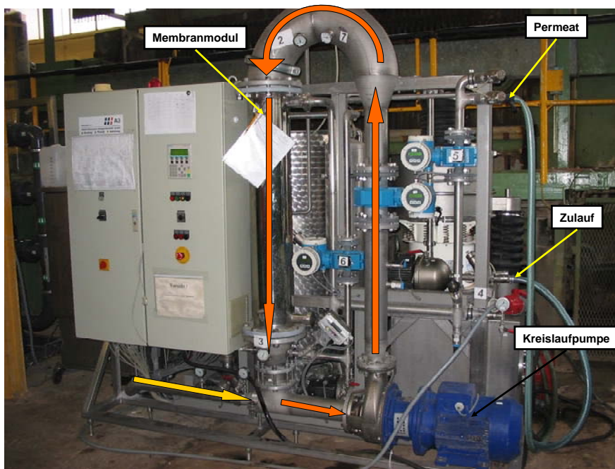
Abbildung 4-52: UF-Anlage zur Behandlung des Emulsionsabwassers
