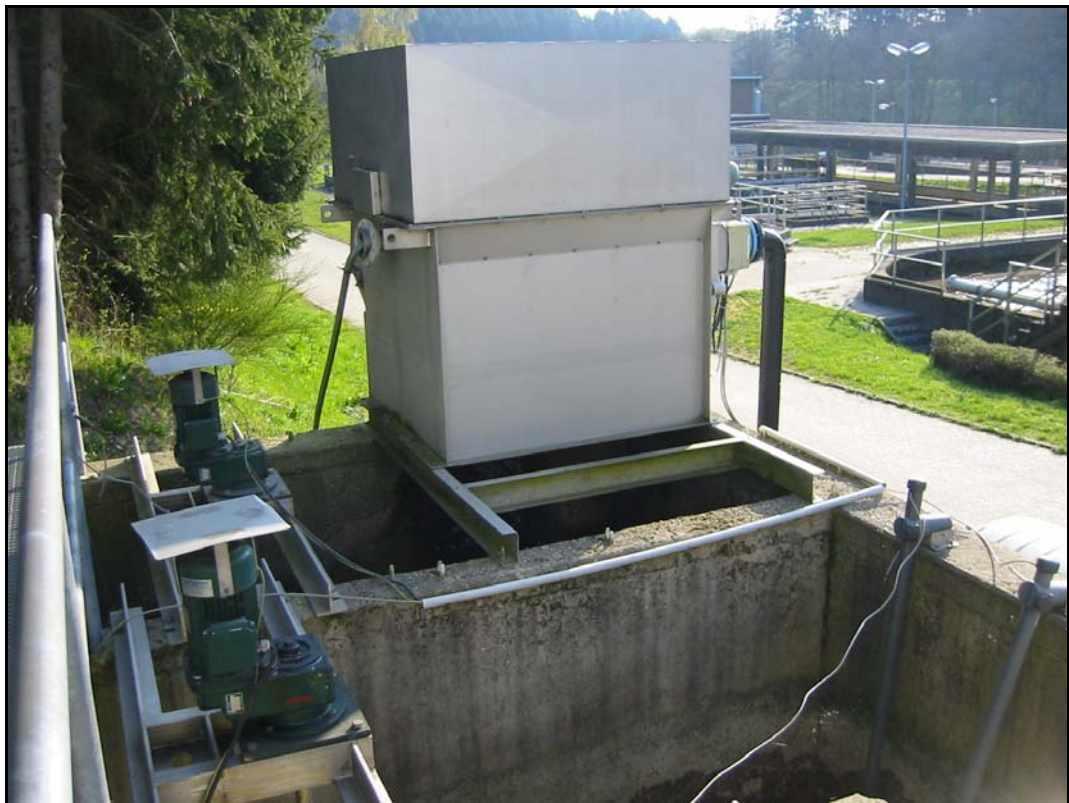
Bild 5-10: Installierter Feinrechen der Firma Contec im Zulauf der MBR-Demonstrationsanlage
