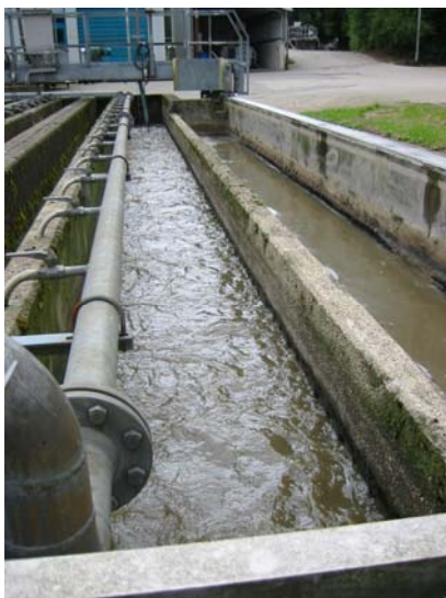
Bild 6-29: Sand- und Fettfang der KA Simmerath
