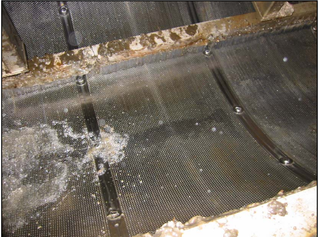
Bild 5-11: Blick in die Siebtrommel des installierten Feinrechens
