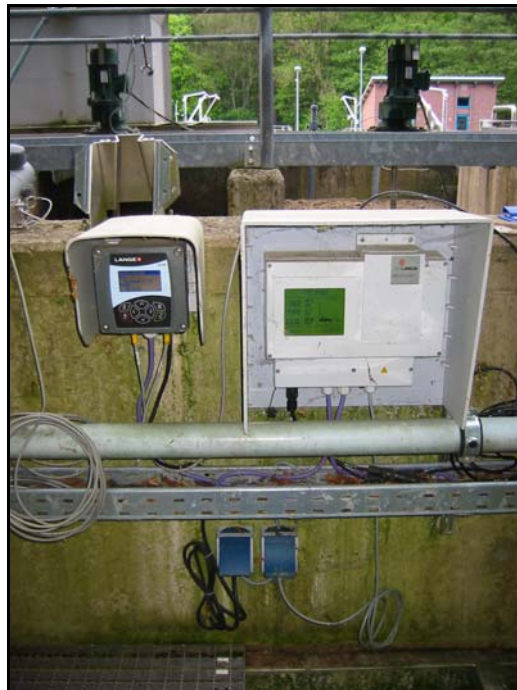
Bild 5-13: Messwertaufnehmer für die Sauerstoff- und Schlammspiegelmessung am Belebungsbecken der MBR-Demonstrationsanlage
