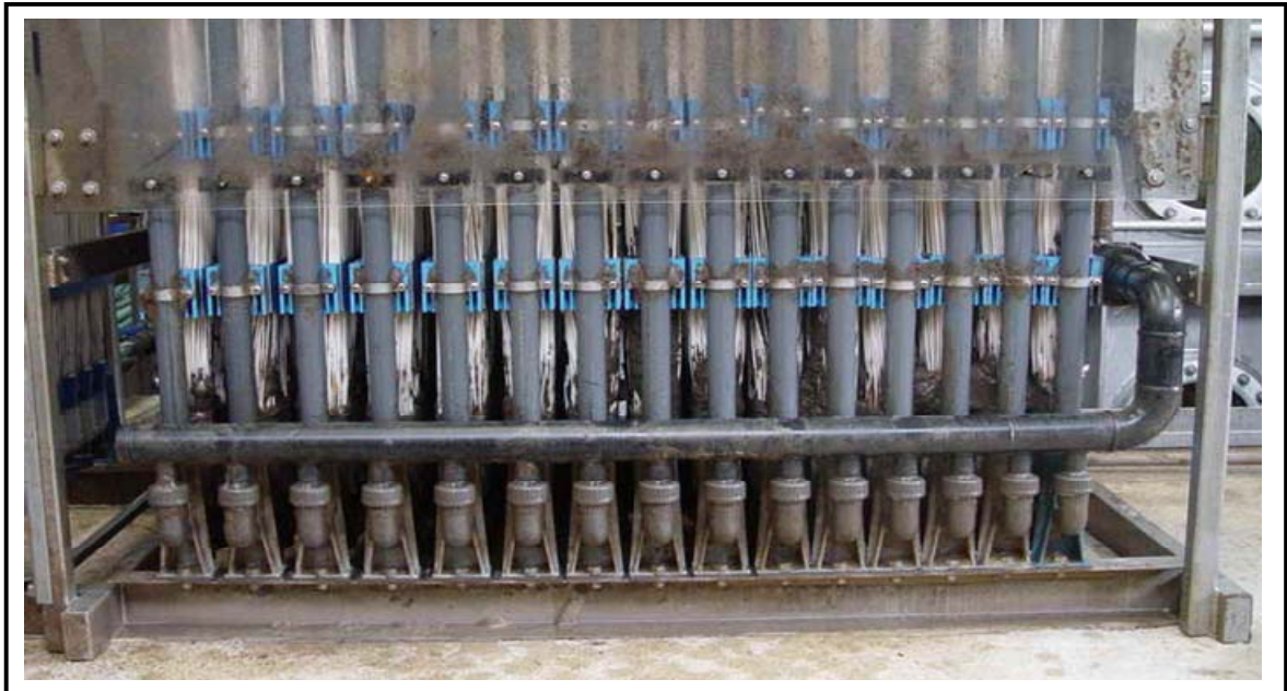
Bild 6-73: Plattendesign des Forschungsvorhabens „Demonstrationsvorhaben Membranfiltration – Kläranlage Simmerath/ Nord-Eifel“
