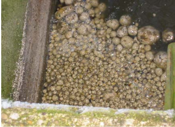
Bild 6-31: Fettbälle im belüfteten Sand- und Fettfang der KA Simmerath
