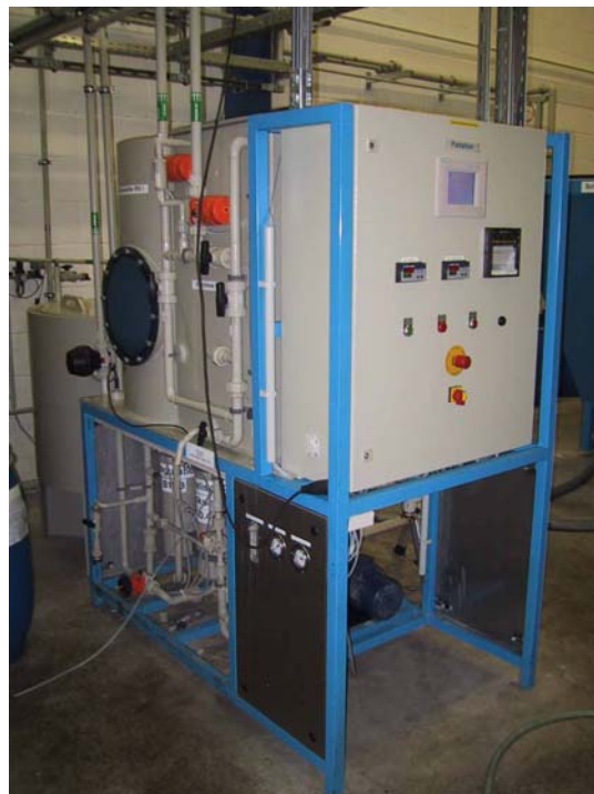
Abbildung 7: Flotationsanlage des Teilstroms B2
