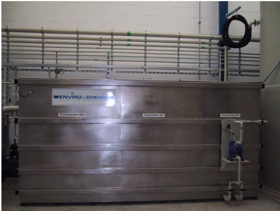
Abbildung 8: Schlammfang und Ölabscheider für das Abwasser aus Teilstrom B1
