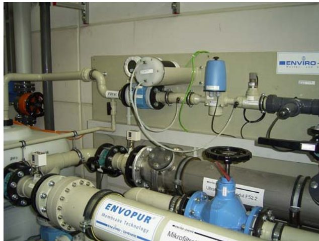
Abbildung 17: Ultra- und Mikrofiltrationsmodul der Pilotanlage, darüber befinden sich die Messgeräte für die Untersuchung des Filtrates. In der Mitte befindet sich das Bypassventil zur Regelung der Umwälzrate
