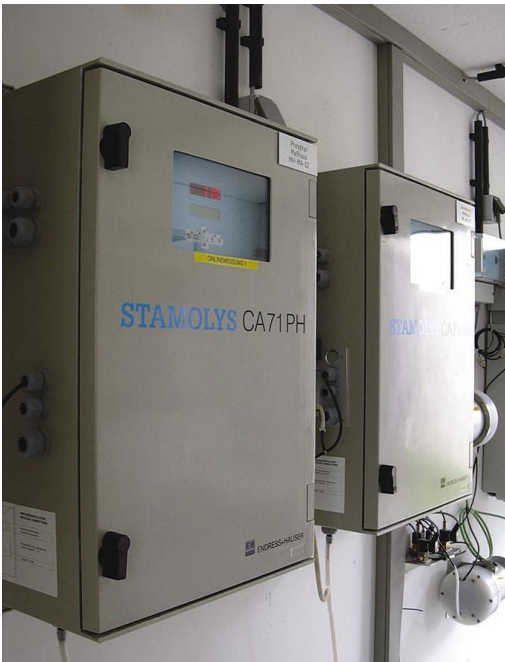
Abbildung 2-10: \text{NH}_4\text{-N} , \text{NO}_3\text{-N} - und \text{PO}_4\text{-P} -Online-Messgeräte im Betriebsgebäude 2
