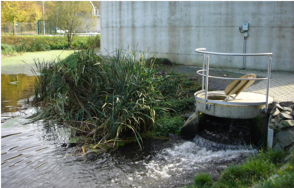
Abbildung 2-11: Ablaufschacht, Pufferteich und SB-Reaktor 1 der KA Weißtal während der Dekantierungsphase
