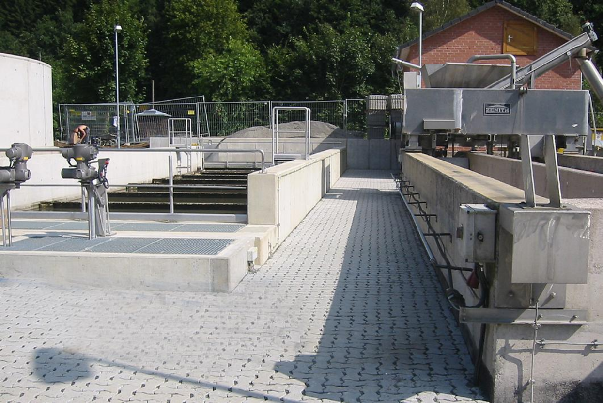
Abbildung 2-3: Vorklärbecken (links) und Sandfang (rechts)
