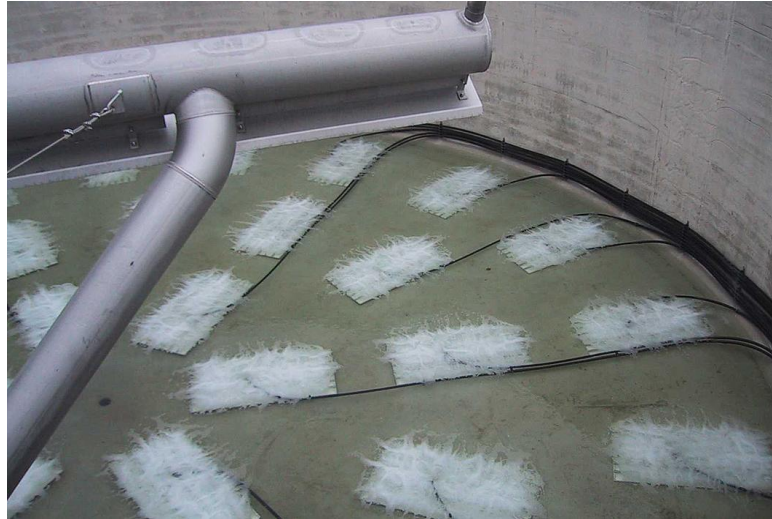
Abbildung 2-9: Blasenbild der Belüfterplatten vor Inbetriebnahme der SBR-Straße
