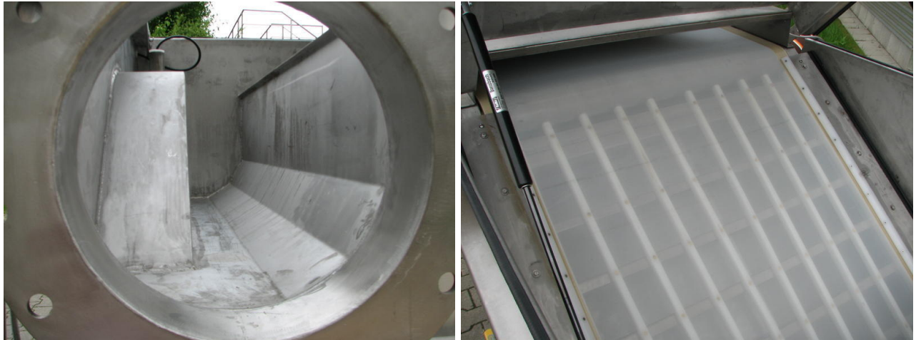
Abbildung 77: Einlaufbereich und Maschenbespannung des Bandsiebes
