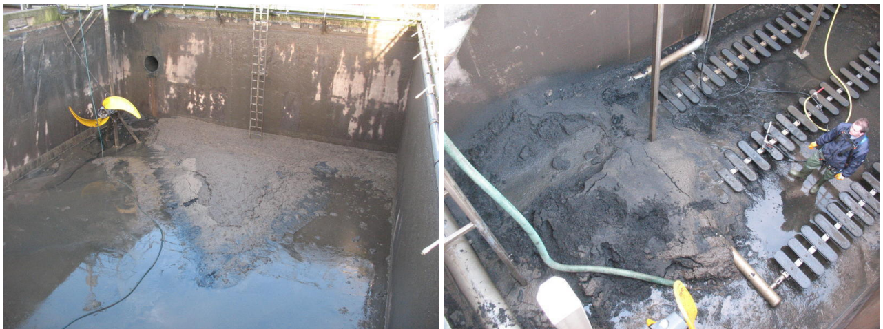
Abbildung 85: Feststoffablagerungen im Belebungsbecken
