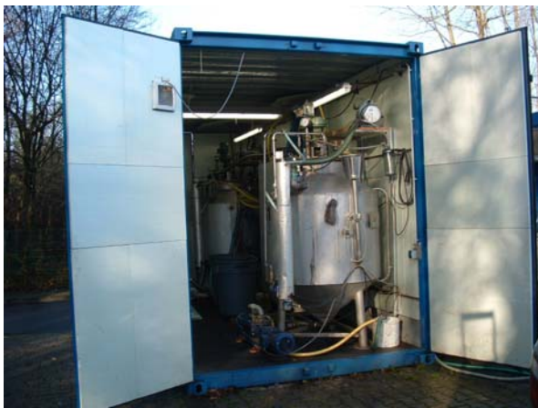
Abbildung 2.11: 2-straßige Schlamm- behandlungsanlage
