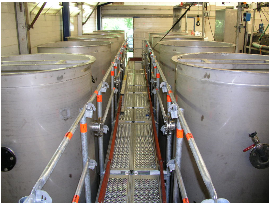
Abbildung 2-4: Aufbau der HTK Neuss
