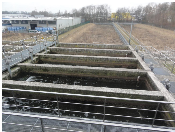
Abbildung 2: ZKA Detmold Filteranlage
