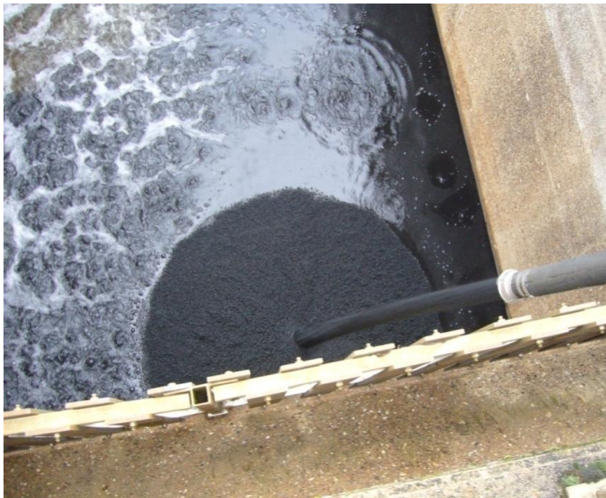
Abbildung 18: Verbandsklärwerk Obere Lutter – Füllung der Filterzelle mit granulierter Aktivkohle
