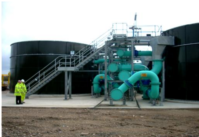
Abbildung 15: Großbritannien – Kläranlage Swindon, Einsatz von granulierter Aktivkohle
