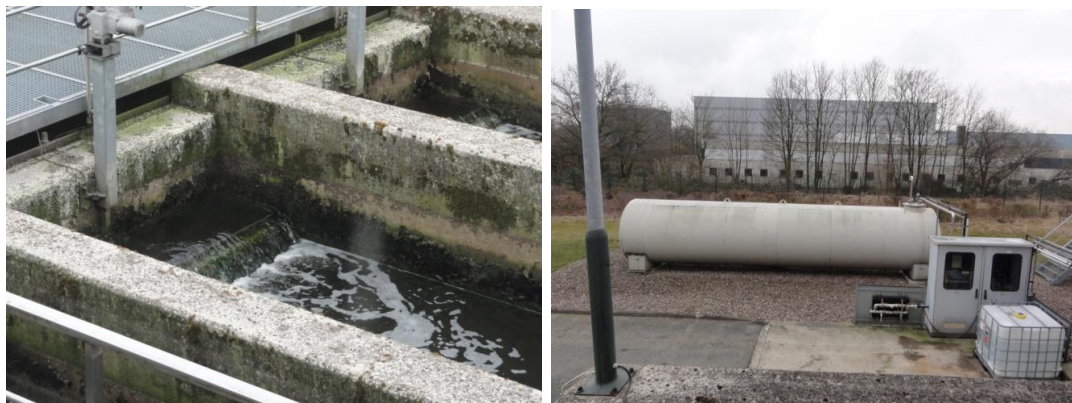
Abbildung 4: Zulaufgerinne Flockungsfiltration Kläranlage Detmold (links)
