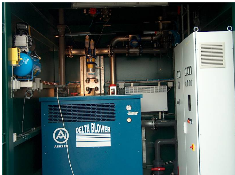
Abbildung 3-4 Detailansicht Maschinen- und EMSR-Technik
