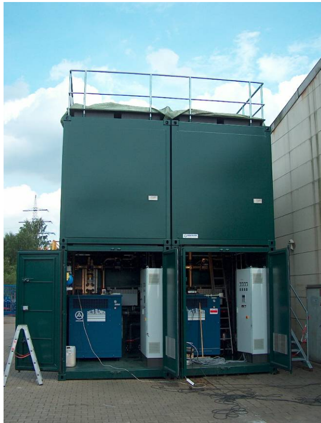
Abbildung 3-3: Maschinen- und EMSR-Technik-Räume der zweistraßigen Membrananlage
