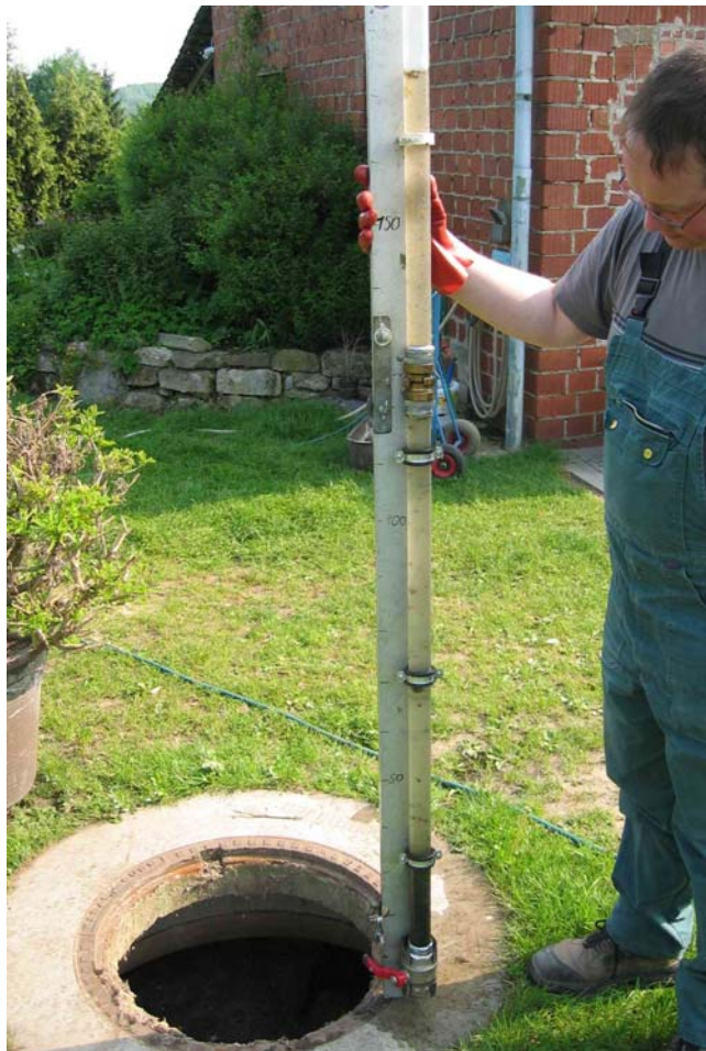
Bild 1: Messung des Schlammspiegels im Rahmen einer Kleinkläranlagenwartung
