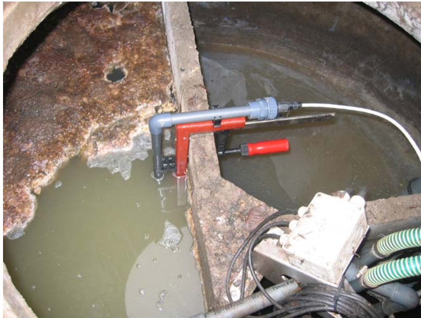
Bild 10: Schlammspiegelmesssystem im eingebauten Zustand
