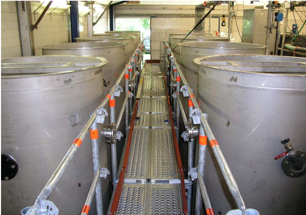
Abbildung 3-1: Aufbau der HTK Neuss
