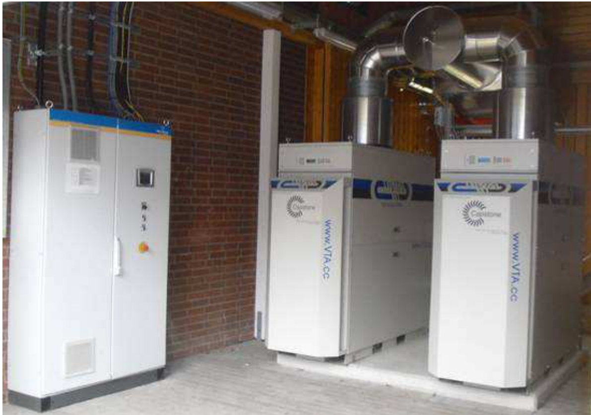
Bild 5.4 2 x 65 kW el -Mikrogasturbinen auf der KA Warendorf
