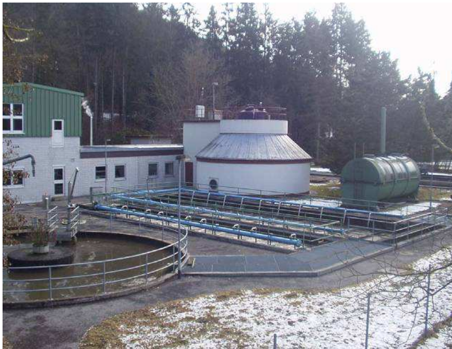
Bild 4.29: Kläranlage Fischingen (Quelle Bailer, 2009)
