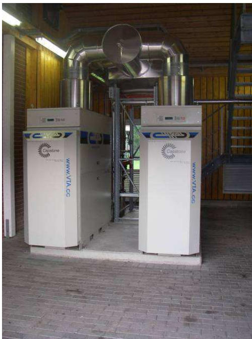
Mikrogasturbinen-Anlage (Capstone, 2*65 kW el ), KA Warendorf
