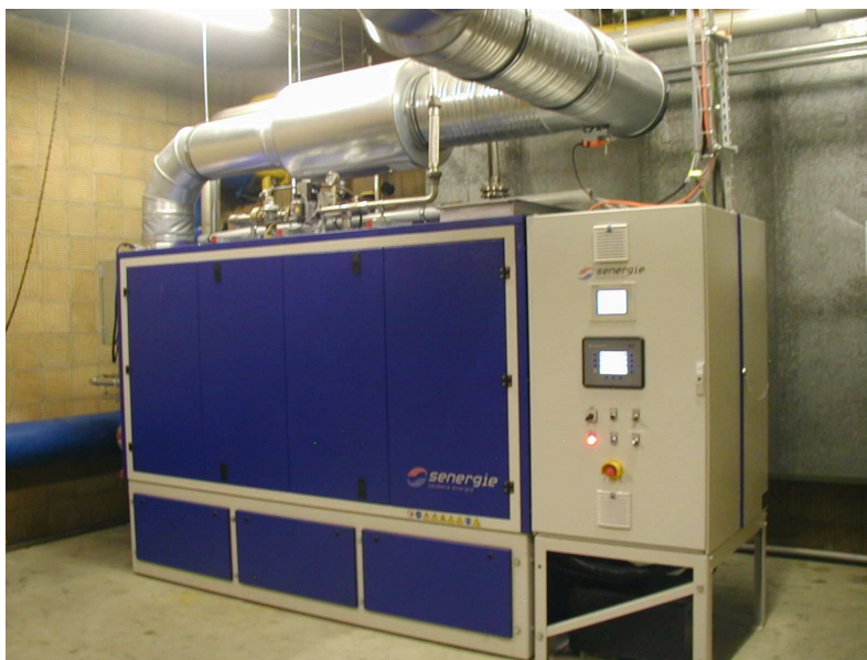
Bild 9.3: BHKW-Modul der Kläranlage Büchel
