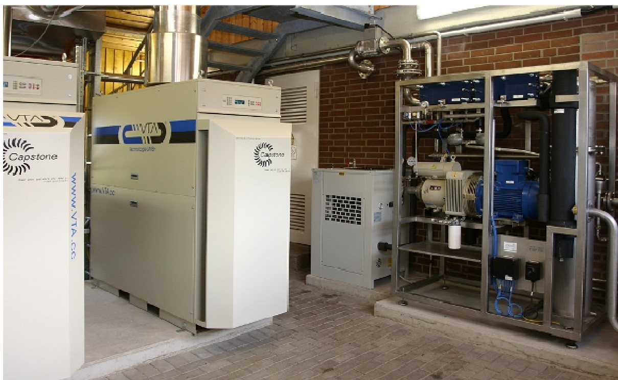
Bild 9.8: Mikrogasturbinen mit Gasaufbereitung (Capstone, 2 x 65kW el )
