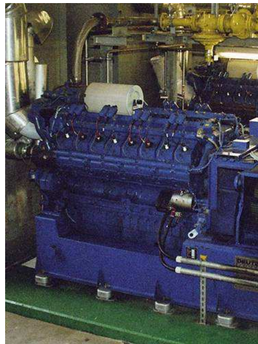
Blockheizkraftwerk (MWM, 4*490 kW el ), KA Buchenhofen
