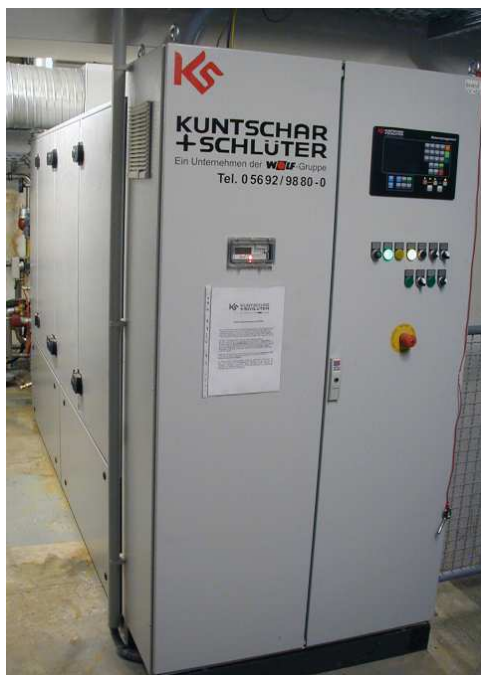
Bild 9.6: Neues BHKW-Modul der Kläranlage Engelskirchen, Baujahr 2011
