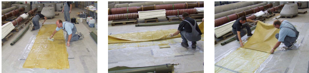
Abb. 33: Auftragen des Harzes mittels Spachtel (links), Wenden des Glasfasergewebes (mittig), Einschlagen des harzgetränkten Gewebes zur Mitte hin (rechts)
