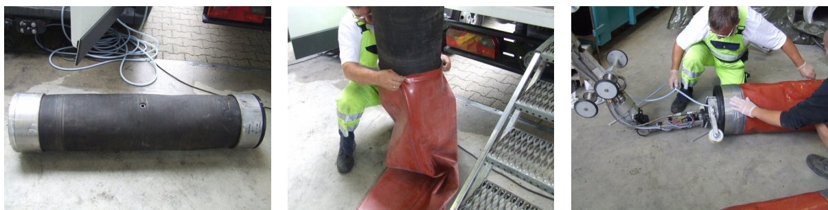
Abb. 21: Verpresspacker für DN 600 (links); Aufbringen des Silikon Schlauches auf den Verpresspacker (mittig); Ankoppeln des Verpresspackers an die Selbstfahreinheit (rechts)
