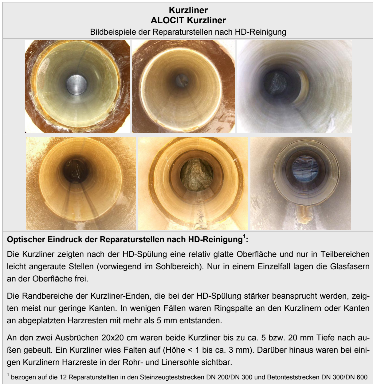
Abb. 54: Bildbeispiele und optischer Gesamteindruck - Reparaturstellen nach HD-Reinigung (ALOCIT Kurzliner)
