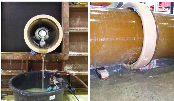
Abb. 11: Wasserzufluss bei Sanierung (links), Undichtigkeit der Muffe bei Wasserfüllung des Rohres (rechts)
