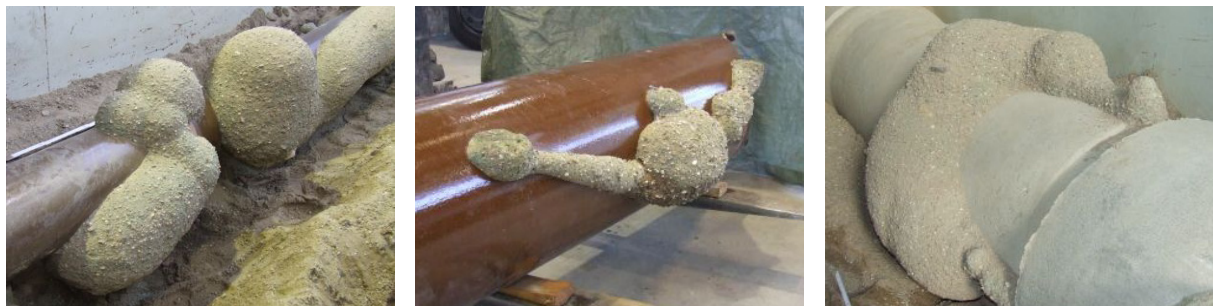
Abb. 19: Bildbeispiel – Detail Rohraußenseite nach Aufgrabung Stz. DN 200 (links), Stz. DN 300 (mittig), Beton DN 600 (rechts)
