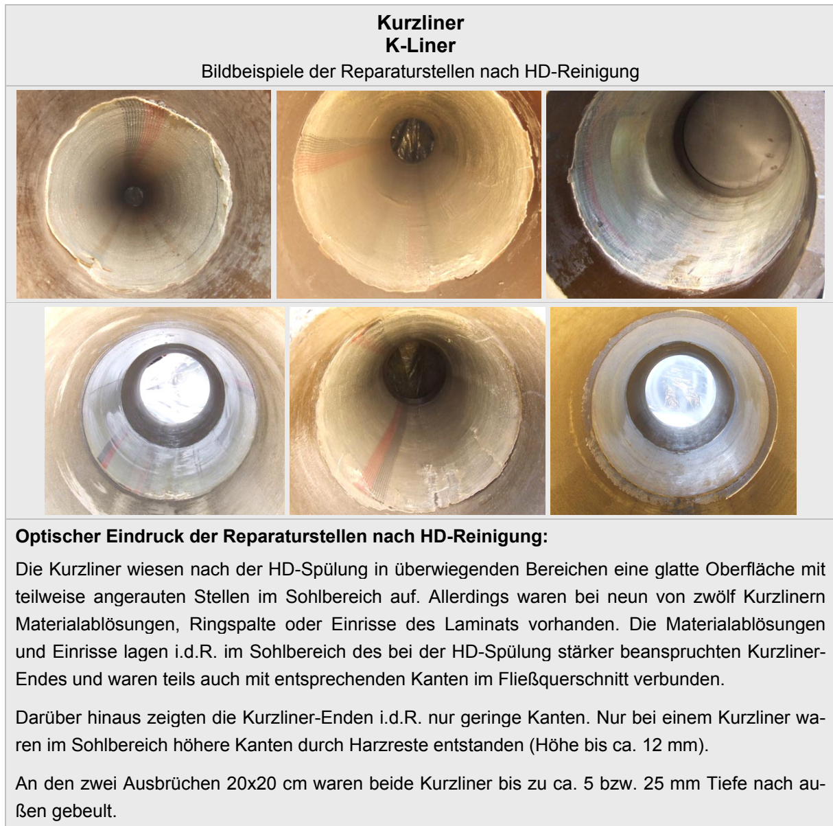
Abb. 56: Bildbeispiele und optischer Gesamteindruck - Reparaturstellen nach HD-Reinigung (K-Liner)
