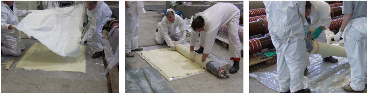
Abb. 45: Auflegen einer weiteren Lage Glasfasergewebe (links), Aufwickeln des harzgetränkten Glasfasergewebes auf den Packer (mittig), Fixierung der Gewebematte mit Kreppband (rechts)
