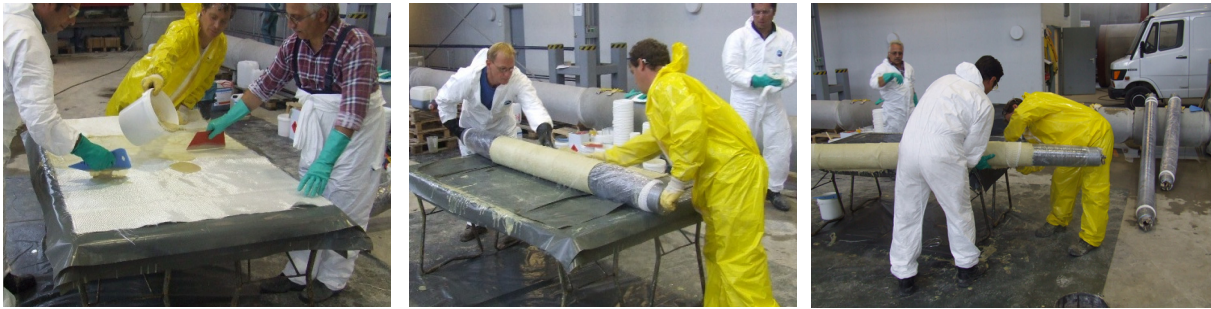
Abb. 42: Auftragen des Harzes (links), Umwickeln des Packers mit dem harzgetränktem Glasfasergewebe (mittig), Lagesicherung des harzgetränktem Glasfasergewebes mit Stülpverbänden (rechts)
