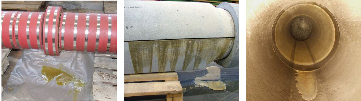
Abb. 31: Harzaustritte - Steinzeugteststrecke DN 200, Schadensbild 3 (links); Betonteststrecke DN 300, Schadensbild 2 (mittig); Betonteststrecke DN 300, Schadensbild 3 (rechts)
