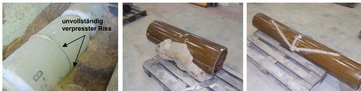
Abb. 22: Bildbeispiel – Detail Rohraußenseite nach Aufgrabung Beton DN 300 (links), Stz. DN 200 (mittig und rechts)
