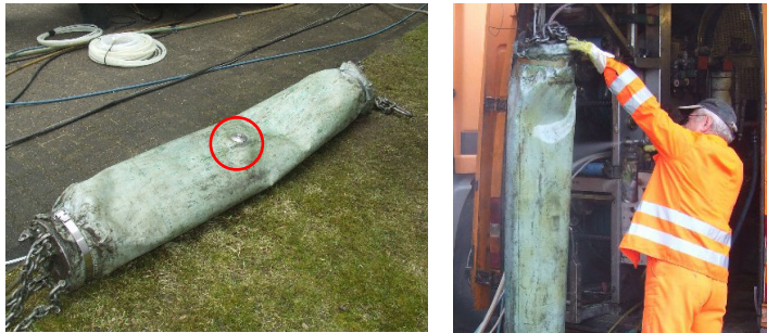
Abb. 18: Verpresspacker DN 300 (links), Auftragen des Trennmittels (rechts)
