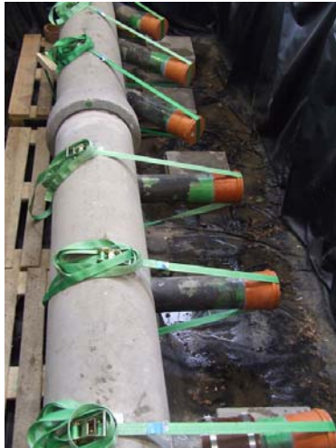
Abbildung 2: Freigelegte Hutprofile während der Dichtheitsprüfung (Verschluss durch PVC-Kappen)
