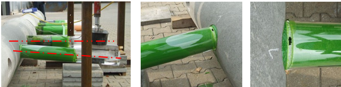
Abb. 41: Abwinklung der Rohre (li) und beschädigtes BRAWOLINER®-Hutprofil nach Abwinklung (mi, re)
