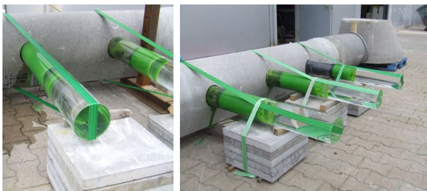
Abb. 42: Undichtigkeit am Stutzen ohne Gummiprofil (li) sowie dichte Stutzen mit Gummiprofil (re, gefärbte Stellen unterhalb der Stutzen = Harz)
