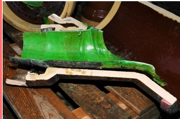
Abb. 85: V17, Schnitt 2, abgelöstes Gummihutprofil und BRAWOLINER®-Hutprofil im 45°-Abzweig, Ablösung vom Steinzeugrohr erfolgte ohne großen Kraftaufwand
