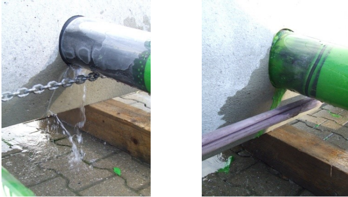
Abb. 45: Wasseraustritte an den Stutzen V5 (li.) und V6 (re.) bei 0,5 bar Wasserdruck
