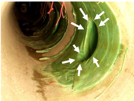
Abb. 134: Krempenbereiche der 90°-Hutprofile mit deutlich sichtbaren Bewegungen des Materials
