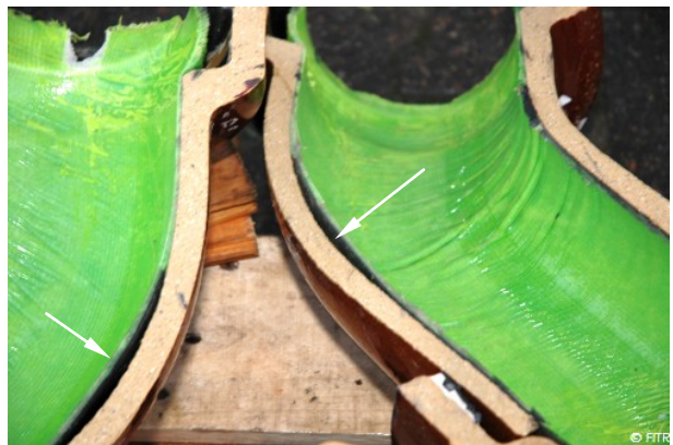
Abb. 99: V18, unvollständige Auskleidung an der Bogenaußenseite
