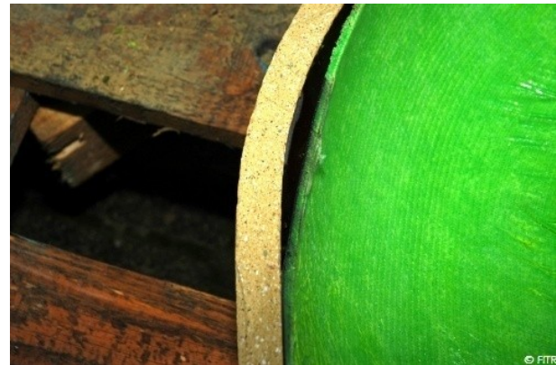
Abb. 113: V19, nicht mit dem Gummihutprofil verklebter Bereich im Bogen
