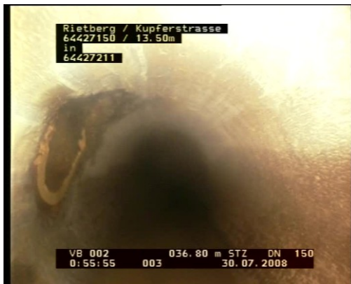
Abb. 148: Einlauf in der Kupferstraße vor der Sanierung
