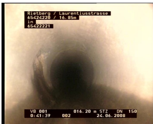
Abb. 150: Einlauf in der Laurentiusstraße vor der Sanierung
