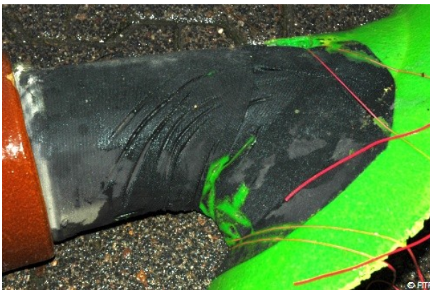
Abb. 104: Falten im Bereich der Abwinklung des 90°-Gummihutprofils in den 45°-Abzweig
