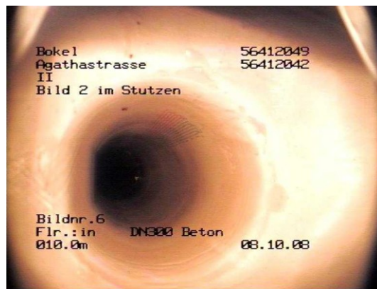
Abb. 155: Einlauf in der Agaathastraße, Blick in den sanierten Einlauf
