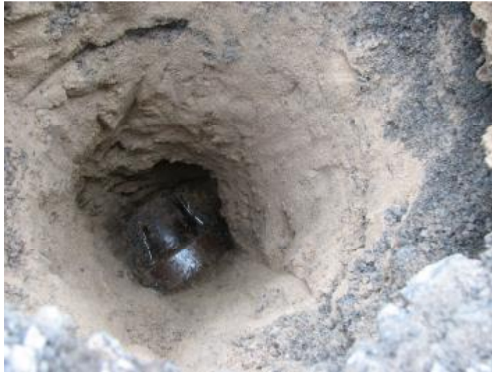
Abbildung 21: Am unteren Ende des Sackungstrichters ist die undichte Muffenverbindung (seitlicher Wasseraustritt) erkennbar
