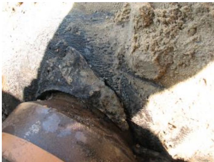
Abbildung 33: Schadensursache: Durch Abplatzen der Vermörtelung verursachte Undichtigkeit am Anschluss des Hausanschlusskanals an den Hauptkanal
