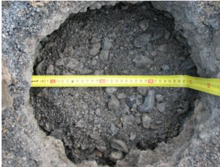
Abbildung 31: Form und Größe der Oberfläche der Absackung
