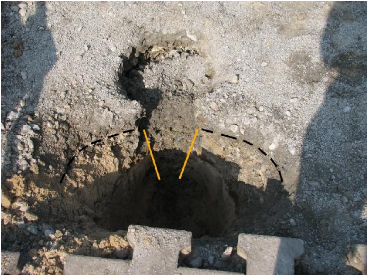
Abbildung 32: Sackungstrichter in der Schottertragschicht, Frostschuttschicht und im Verfüllboden oberhalb der Undichtigkeit am Regenwasserkanal
