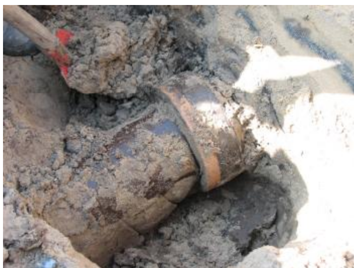
Abbildung 34: Keine erkennbare Hohlraumbildung an der Rohrbettung
