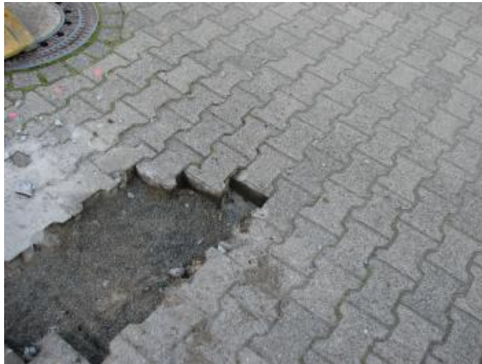
Abbildung 29: Pflasterbettung nach dem vorsichtigen Entfernen einiger Pflastersteine an der Schadensstelle
