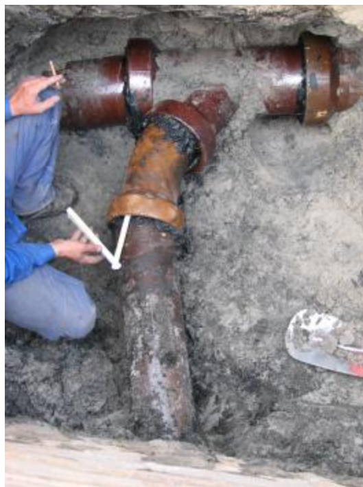
Abbildung 12: Undichtigkeit durch fehlende Teerstrickdichtung an Muffenverbindung im Hausanschlusskanal
