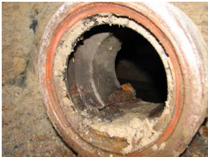
Abbildung 22: Freigelegte Muffe mit ringförmig erkennbarer Sandinfiltration, dahinter Anschlussstutzen an den Beton-Hauptkanal
