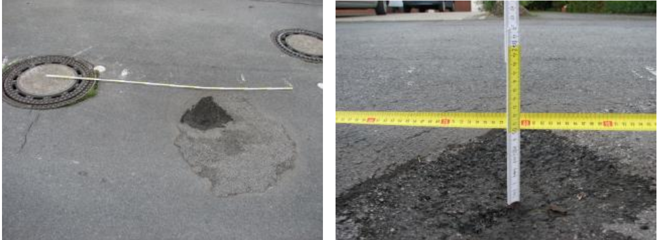
Abbildung 4: Fahrbahnschaden: Muldenartige Verformung, Ausbruch, Flickstelle
