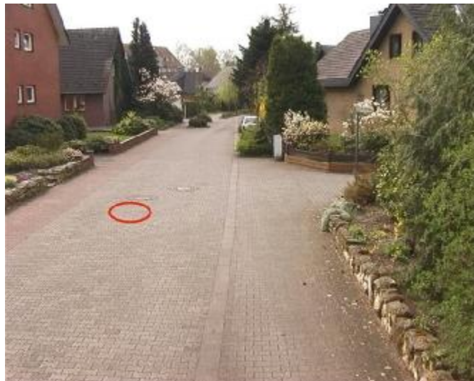
Abbildung 24: Frontkamerabild der messtechnischen Zustandserfassung (12.04.2005): Muldenförmige Setzung nicht erkennbar
