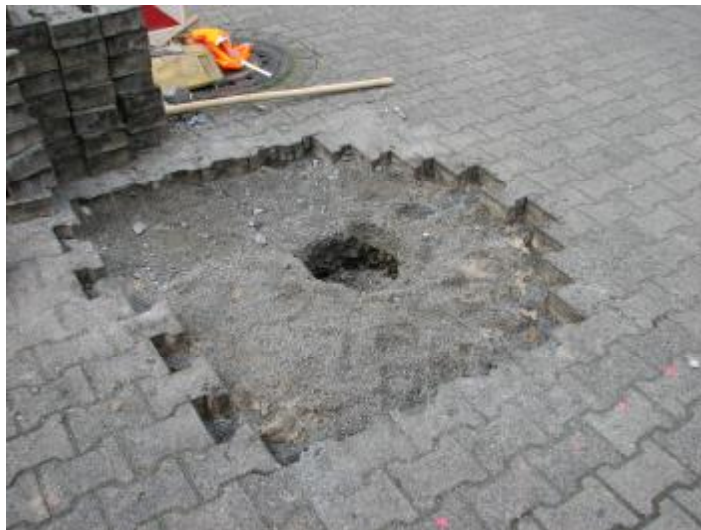
Abbildung 30: Beim Entfernen weiterer Pflastersteine brach die Tragschicht ohne Bindemittel plötzlich kreisförmig ein
