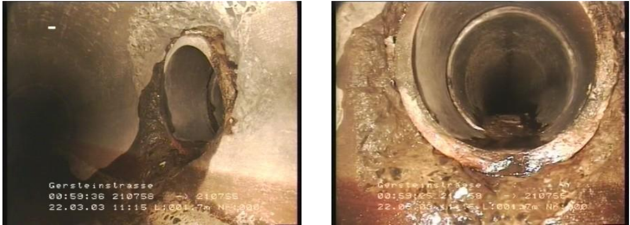
Abbildung 23: Schadenssituation im Hauptkanal (links) und im Bereich des Hausanschlusstutzens mit Blick in den Anschlusskanal (rechts)
