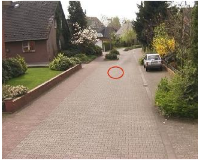
Abbildung 14: Frontkamerabild der messtechnischen Zustandserfassung (12.04.2005): Muldenförmige Setzung kaum erkennbar
