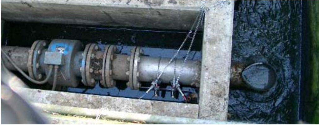
Bild 3.1: MID-Messstelle gedükert durch einen Auslaufbogen im Ablauf der Messrohrleitung
