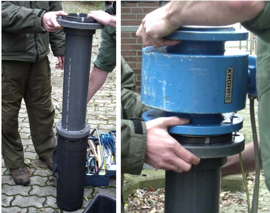
Bild 3.2: Vor-Ort-Montage eines tragbaren MID (DN 125) zur mobilen Vergleichsmessung
