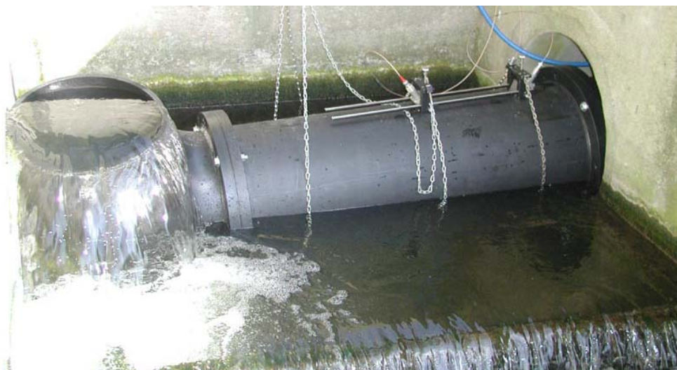
Bild 3.7: Aufstauereinrichtung zur Durchflussmessung mittels des Ultraschall-Laufzeitdifferenzenverfahrens in der Freispiegelkanalisation
