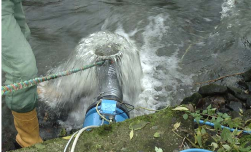
Bild 3.3: Messung mittels eines tragbaren MID mit Auslaufbogen (hier: Einleitungsstelle einer Kläranlage)
