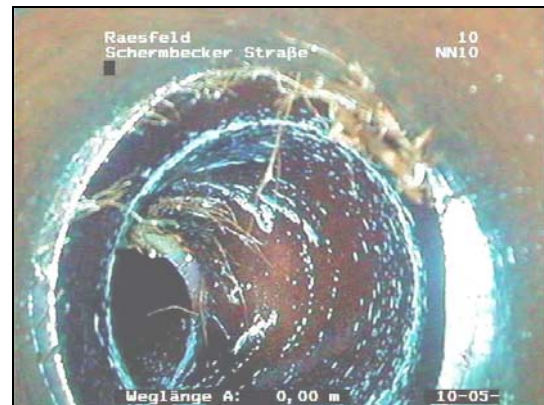
Abb. 32: Blick aus dem Hauptkanal in die Hausanschlussleitung. Wurzeln wurden insbesondere in den Rohrverbindungen im Anschlussbereich festgestellt.
