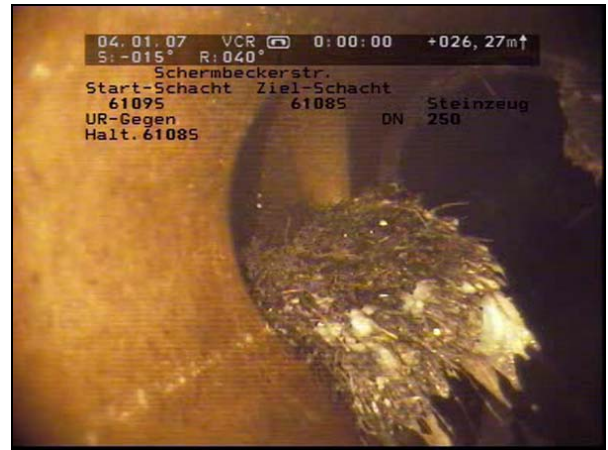
Abb. 8: Wurzeleinwuchs durch einen seitlichen Zulauf. Die Wurzeln haben in der angeschlossenen Leitung ein Polster gebildet, das in den Hauptkanal hereinragt und dort ein Abflusshindernis bildet. (Haltung 6109S - 6108S, 26,27 m).
