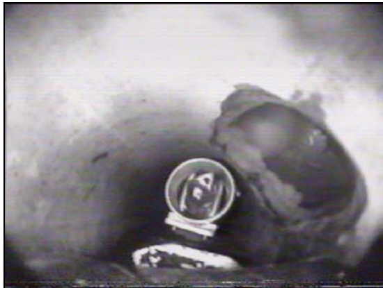
Abb. 26: Einsatz des Systems SPE [8] zur Positionierung einer Reinigungsdüse mit Vorstrahl im Einmündungsbereich einer Grundstücksentwässerungsleitung, vor dem Einschwenken in die HAL.
