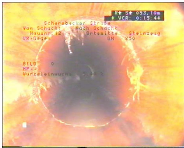
Abb. 3: Wurzeleinwuchs im Hauptkanal vor der Wurzelentfernung und Sanierung der Leitung (Haltung 6109S – 6108 S - 6092S, 53,1 m).
