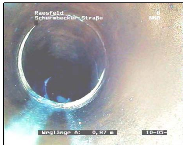
Abb. 38: Versatz in einer alten Grundstücksentwässerungsleitung.
