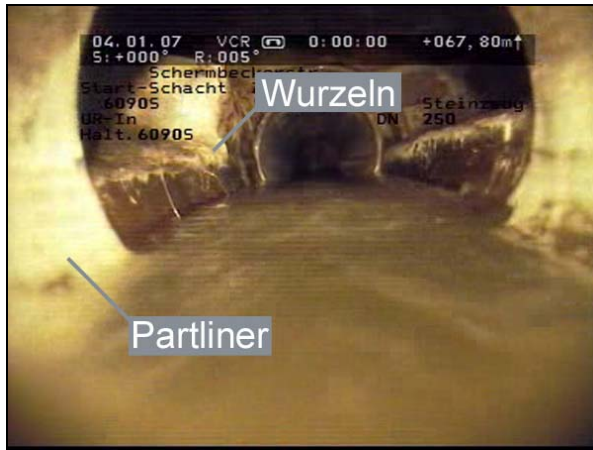
Abb. 7: Wurzeleinwuchs im Schacht des Hauptkanals. Im Bereich der Berme sind Wurzeln zu erkennen. (Haltung 6090S – 6091S, 67,8 m).
