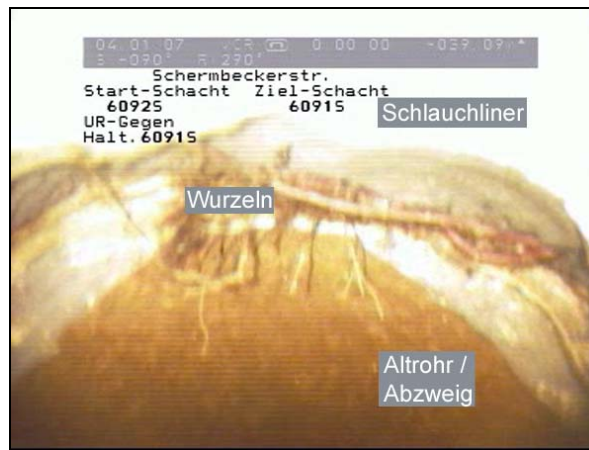
Abb. 20: Einmündungsbereich einer Grundstücksentwässerungsleitung. An der Grenze zwischen Schlauchliner und einmündender Leitung befinden sich Wurzeln, die den Querschnitt der einmündenden Leitung vermindern.
