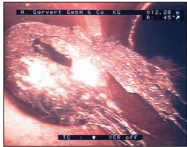
Abb. 4: Wurzeleinwuchs im Einmündungsbereich einer Grundstücksentwässerungsleitung vor der Wurzelentfernung und Sanierung der Leitung (Haltung 6109S - 6108S, 12,28 m).
