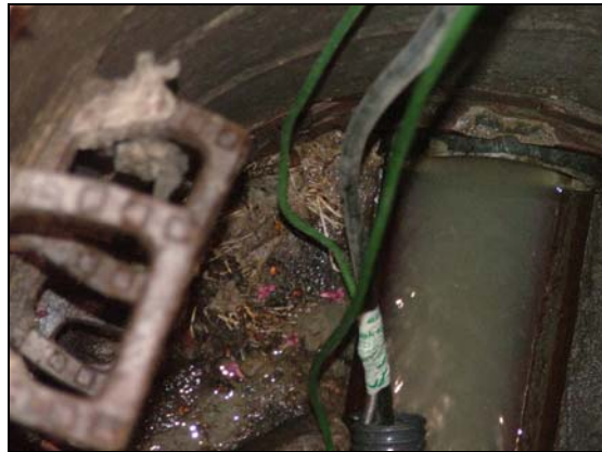
Abb. 6: Wurzeleinwuchs in einem Schacht. Die Wurzeln wachsen höchstwahrscheinlich durch die gemauerten Schachtböden ein. (vgl. auch Abb. 7)
