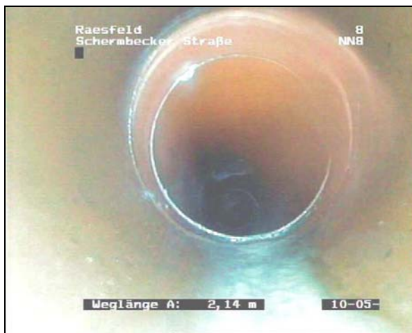
Abb. 37: Werkstoffwechsel in der Leitung mit der laufenden Nr. 8. Hier wurde bereits ein Teil der Grundstücksentwässerungsleitung erneuert und ein Revisionschacht eingebaut.
