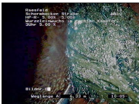
Abb. 35: Wurzeleinwuchs in der Anschlussleitung mit der laufenden Nr. 10: Das Erscheinungsbild der Wurzeln lässt vermuten, dass diese Wurzeln nicht von den Kastanienbäumen auf der Schermbecker Straße stammen.
