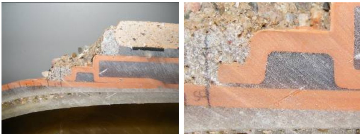
Abbildung 2: Harzaustritt aus einer undichten Verbindung
