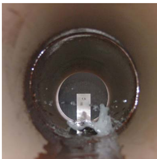
Abb.5: Wassereintritt bei einem Außenüberdruck von ca. 1,2 bar. Versagen des Dichtelementes.
